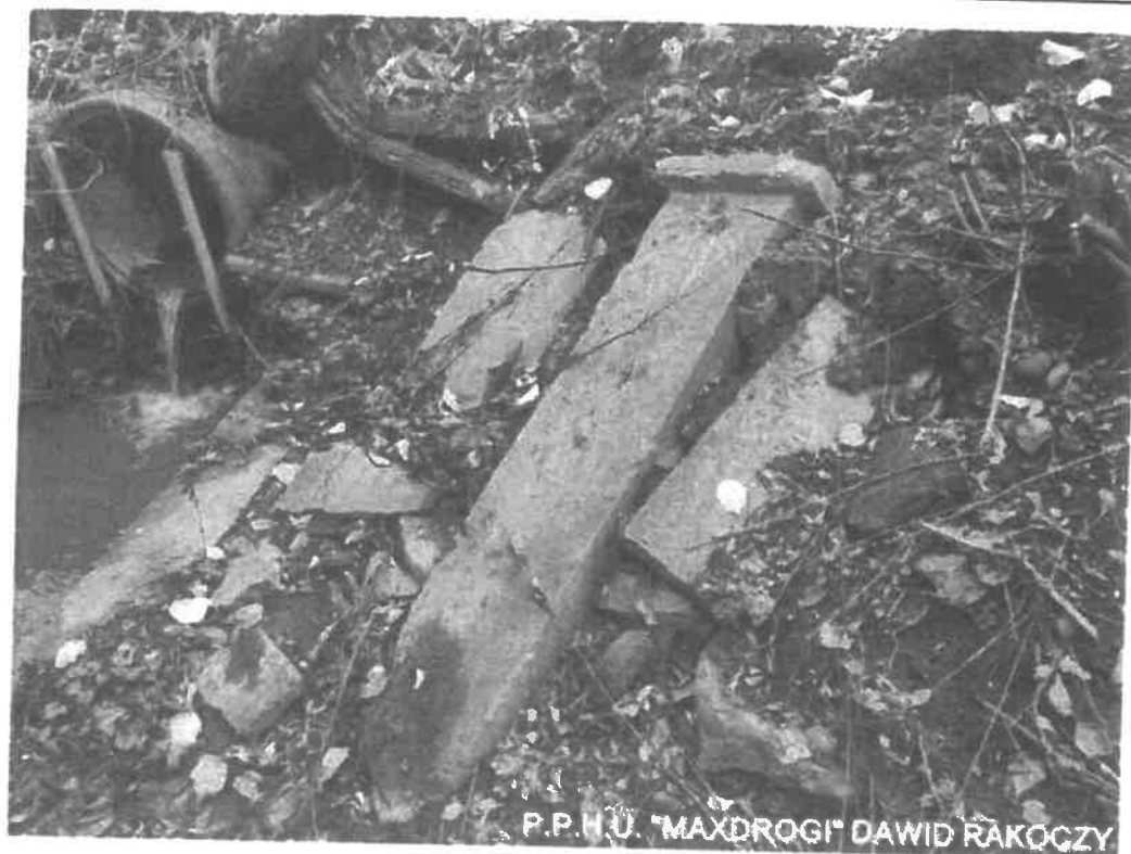
Fot. 6. Zabezpieczenie skarpy od strony wylotu luźnymi prefabrykatami żelbetowymi to tylko próba doraźnego zabezpieczenia skarpy nie przynosząca pożądanego efektu, wykonana niezgodnie ze sztuką budowlaną
