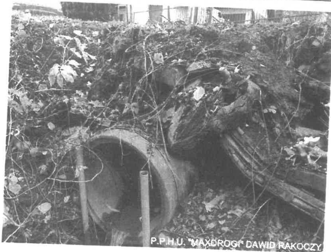
Fot. 7. Widoczny konar drzewa wrastającego w część prefabrykatów rurowych od strony wylotu, który spowodował destabilizację i przemieszczenie kręgów wylotu przepustu
