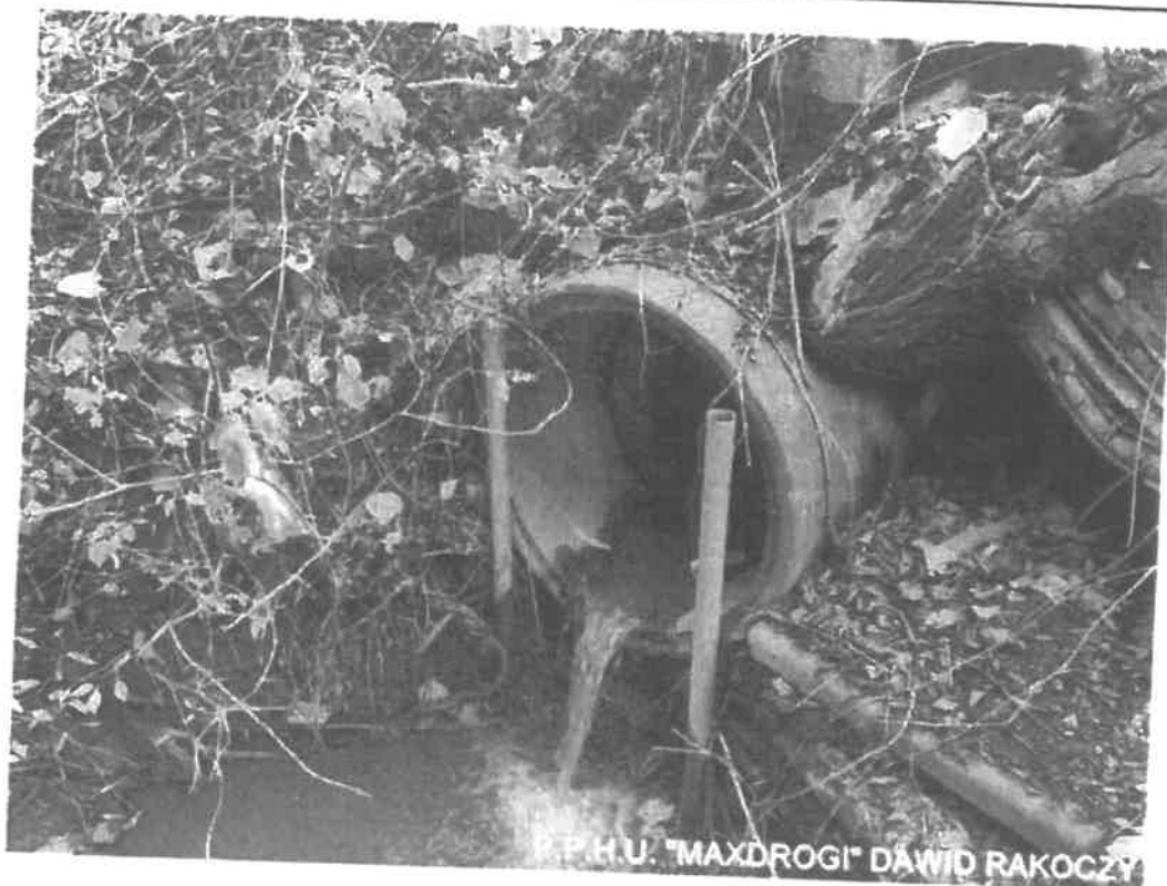
Fot. 8. Niewmocnione dno koryta ciek od strony wylotu wykazuje głęboką wyrwę i ubytek skutkujące podmyciem fundamentu pod kręgami zagrażając przemieszczeniu się części rurowej przepustu. Doraźnie zabezpieczono przed destabilizacją kręgów dwoma stalowymi słupkami z rur
