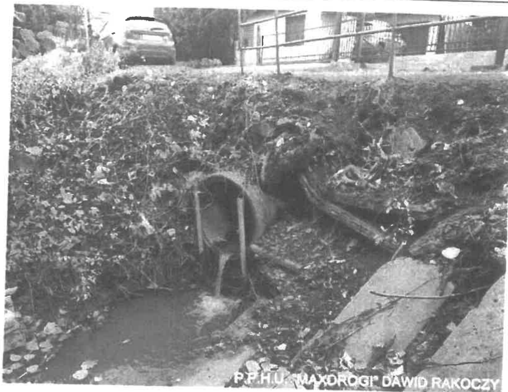
Fot. 5. Zapadanie się, osuwisko i ubytki skarpy od strony wylotu, zagrażające osunięciem się korpusu drogowego z częścią jezdni wskutek braku umocnienia skarpowego lub konstrukcji oporowej czołowej przepustu
