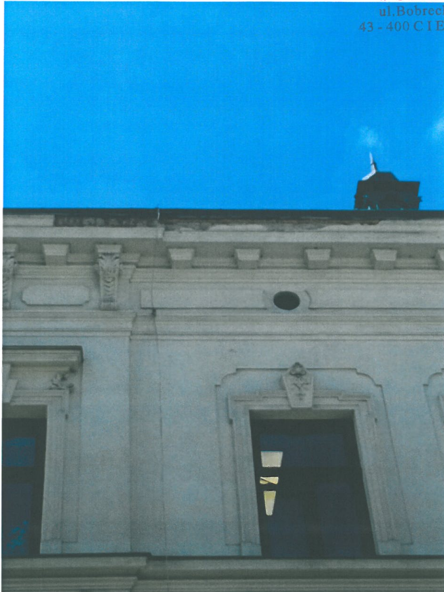
Fot.3. Widoczne ubytki fragmentu gzymsu
