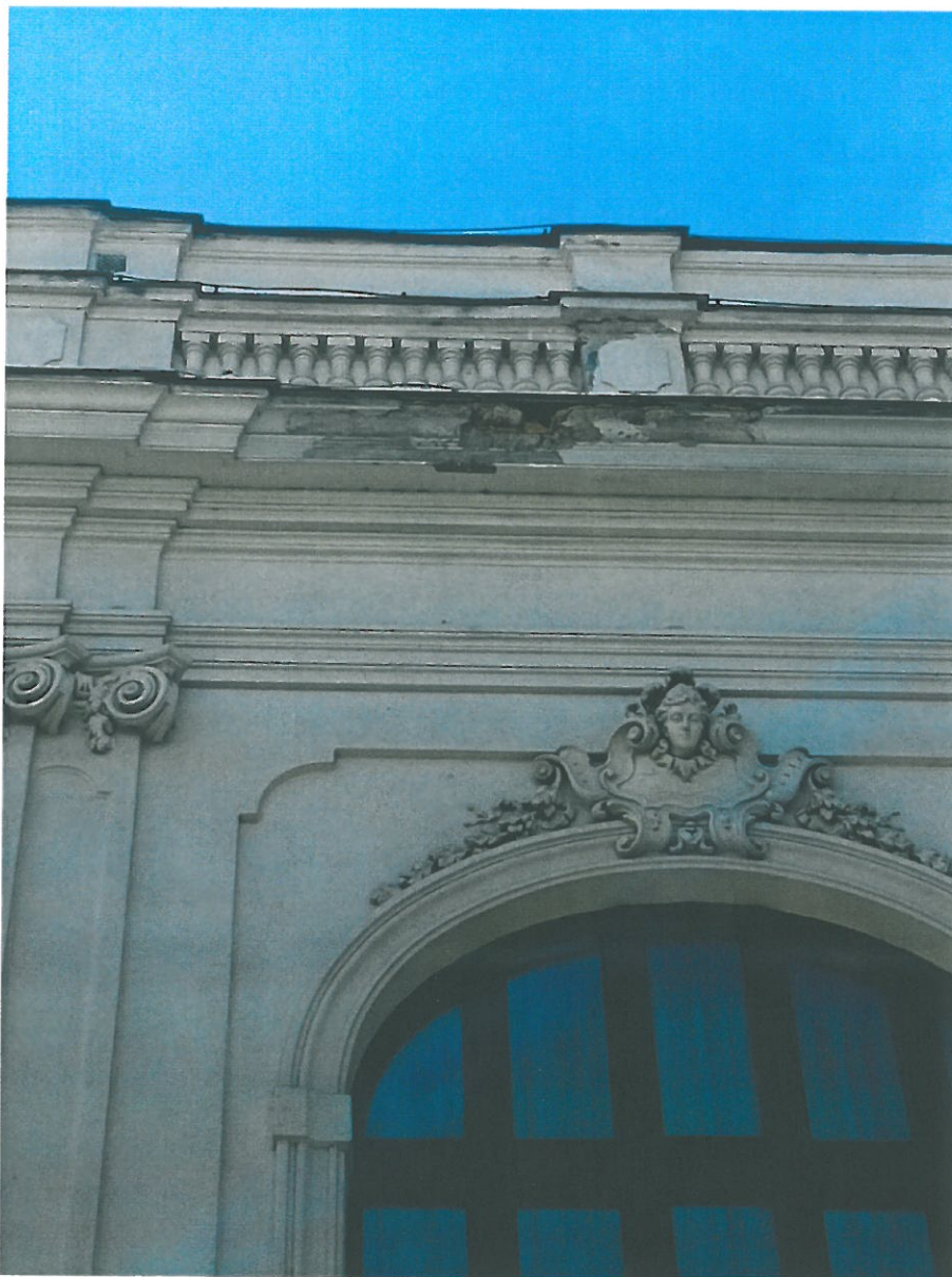
Fot.1. Widoczne ubytki fragmentu gzymsu
