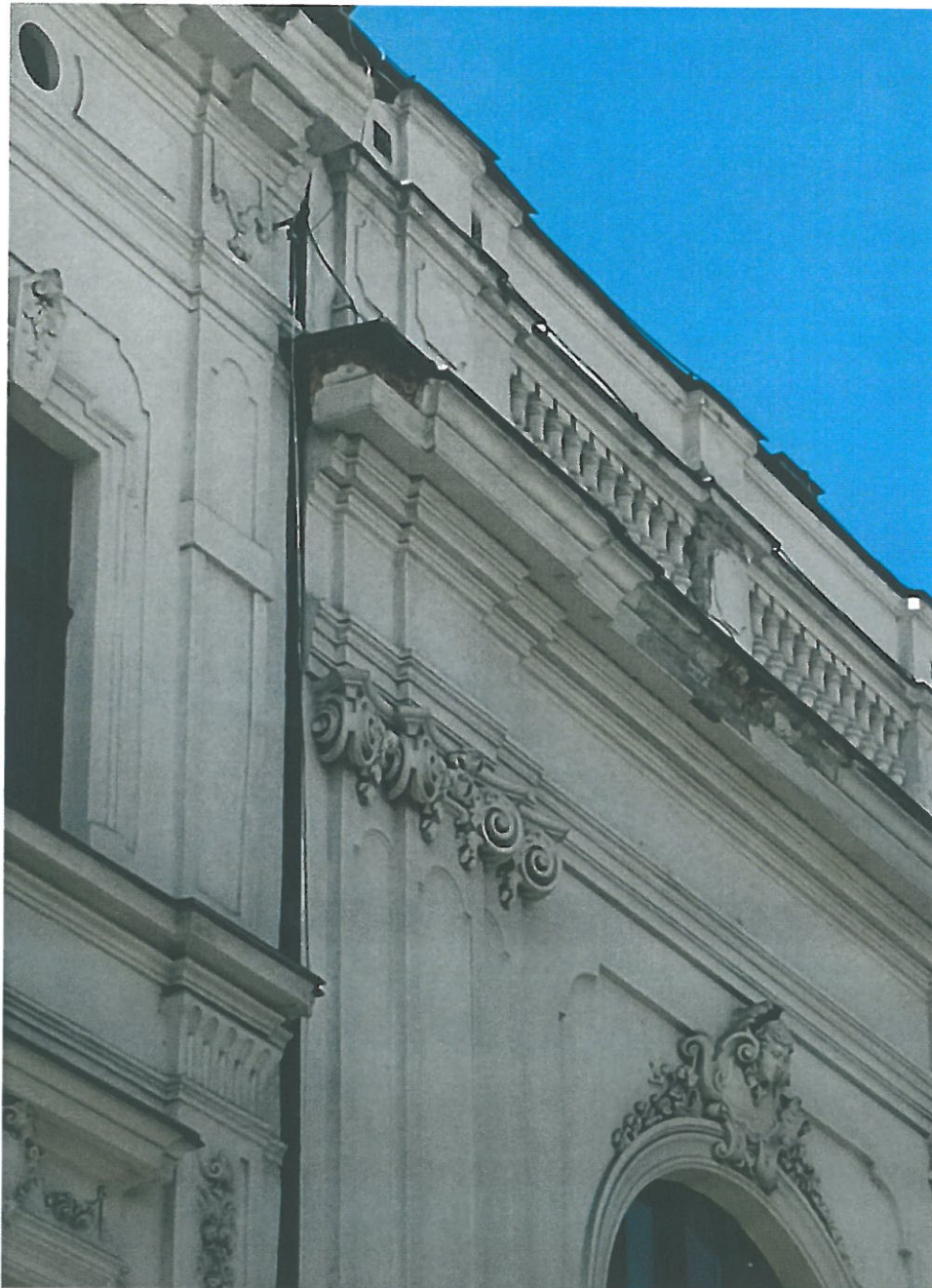
Fot.4. Widoczne ubytki fragmentu gzymsu
