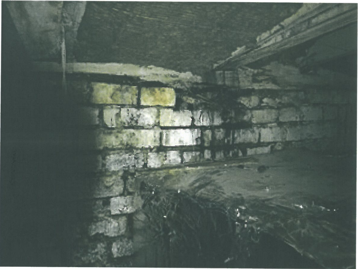
Fot. 3. Widok krokwi koszowej oraz stanu istniejącego murlat.
