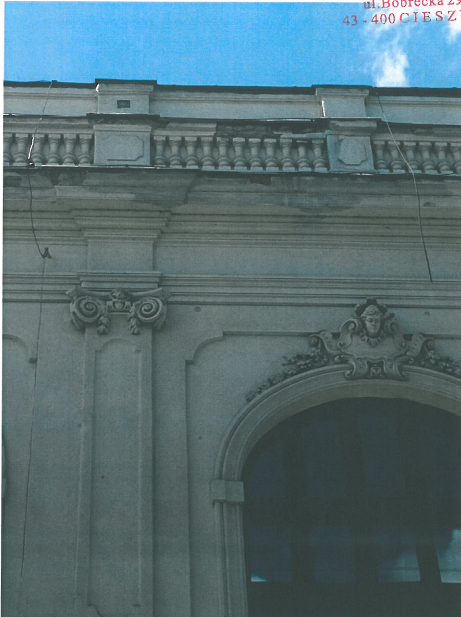
Fot.2. Widoczne ubytki fragmentu gzymsu oraz w kolorystyce obiektu.
