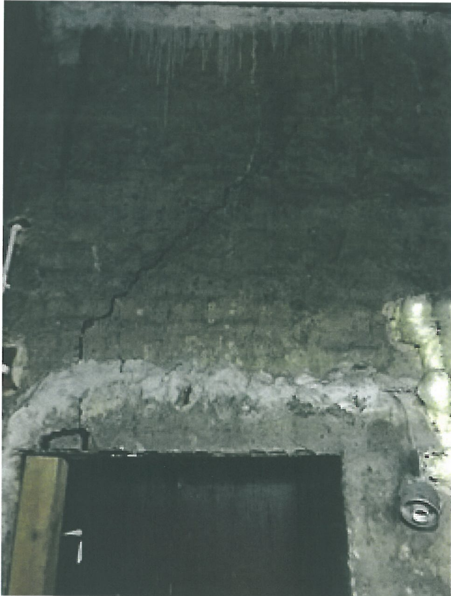
Fot.4. Widok pęknięcia ściany.
