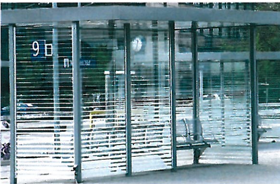
Wiata przystankowa zabezpieczona paskami różnej szerokości
