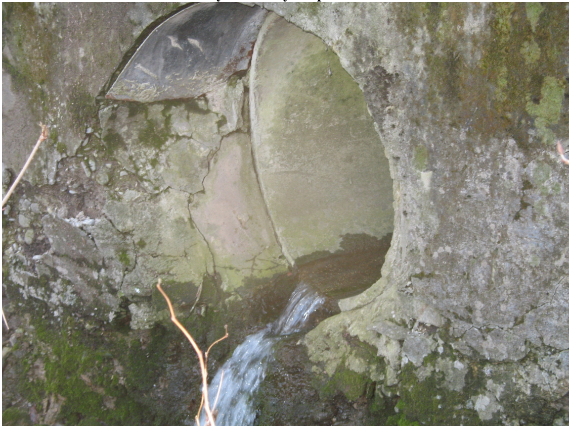
Fot.8. Wylot. Widać skorodowany beton obudowy wylotu.
