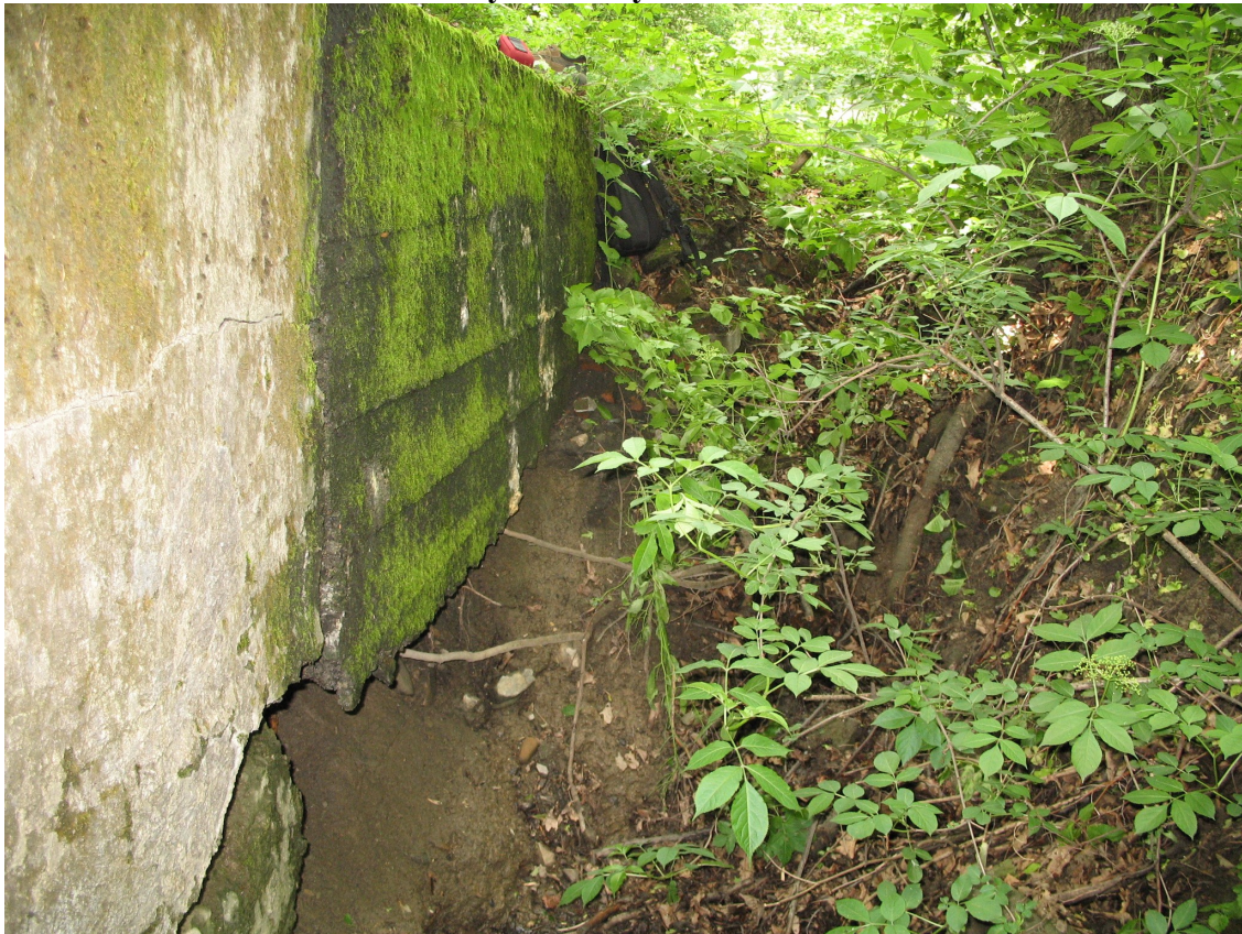
Fot. 6. Wylot. Wyrwa pod skrzydłem lewobrzeżnym.
