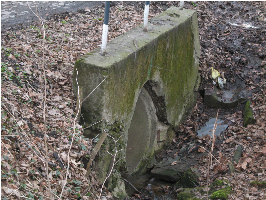
Fot. 2 . Obudowa wlotu. Widoczne zakończenie rowu.
