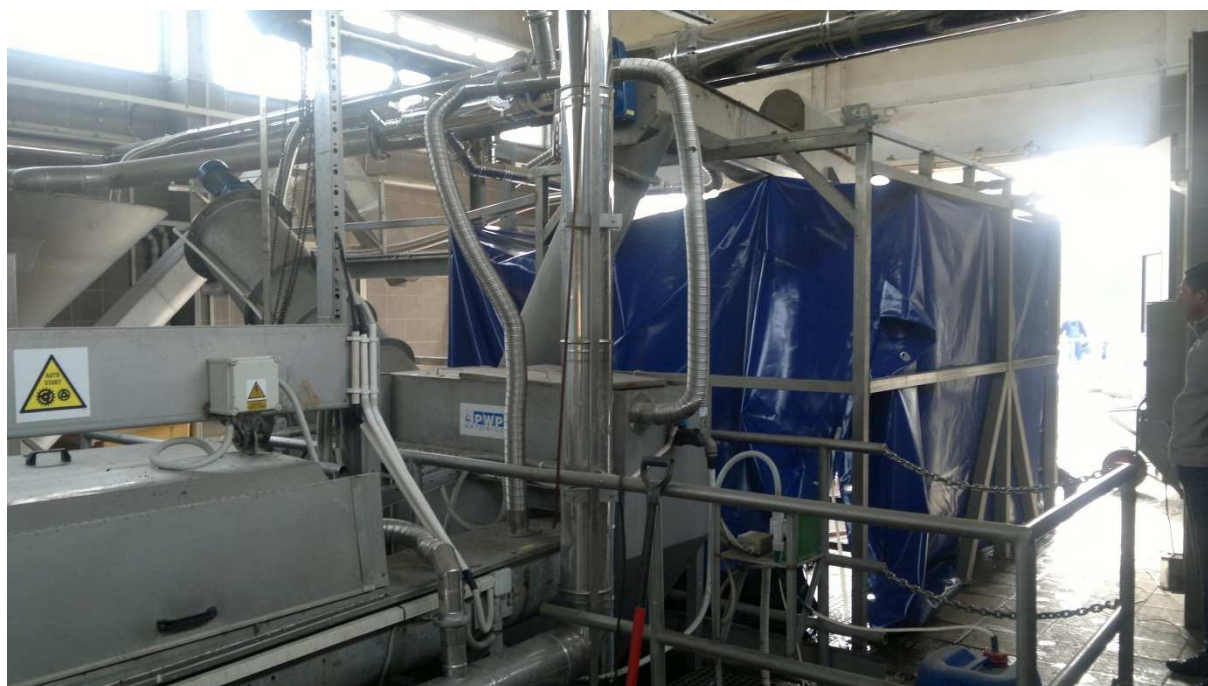
Rys. 8. Zhermetyzowane stanowisko odbioru skratek.
