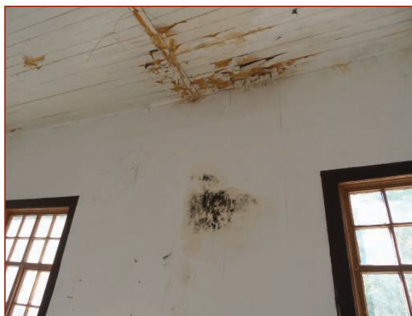
Fot. 78. Grzyb na ścianie w pomieszczeniu 3.6.
