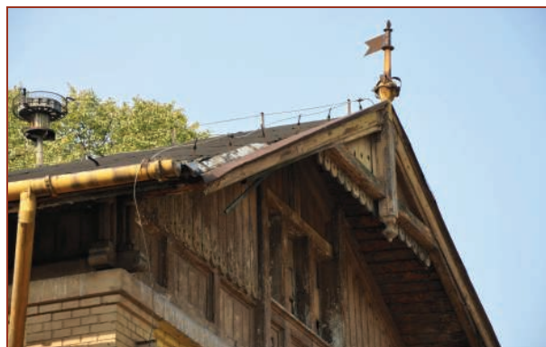
Fot. 47. Spróchniała i uszkodzona konstrukcja wieszarowa
