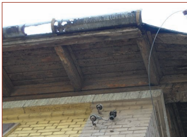
Fot. 75. Dziurawa rynna na budynku piętrowym
