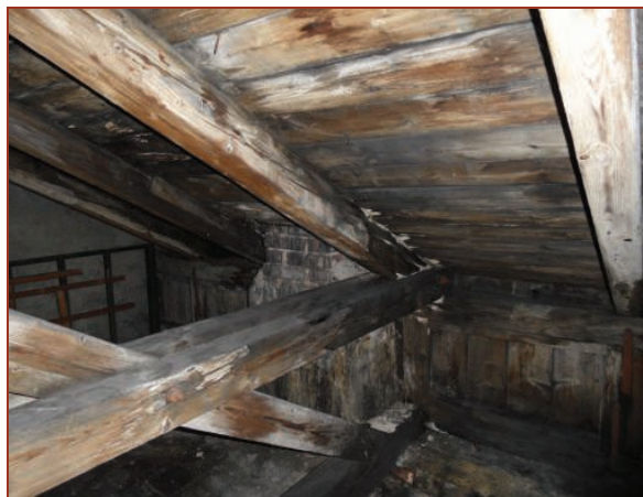
Fot. 51. Zagrybione elementy więźby jednowieszakowego
