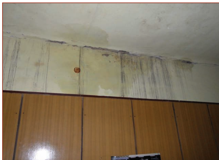
Fot. 40. Mokre plamy na ścianie piętra i stropie
