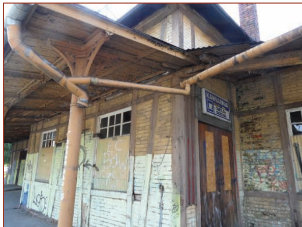
Fot. 82. Brak rury spustowej przy słupie wiaty
