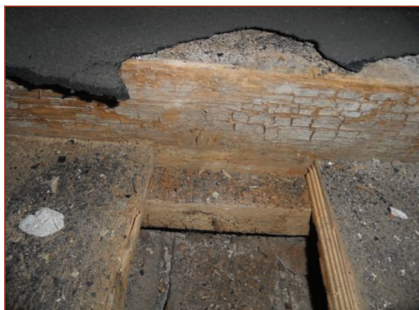
Fot. 42. Spróchniała belka w stropie nad parterem
