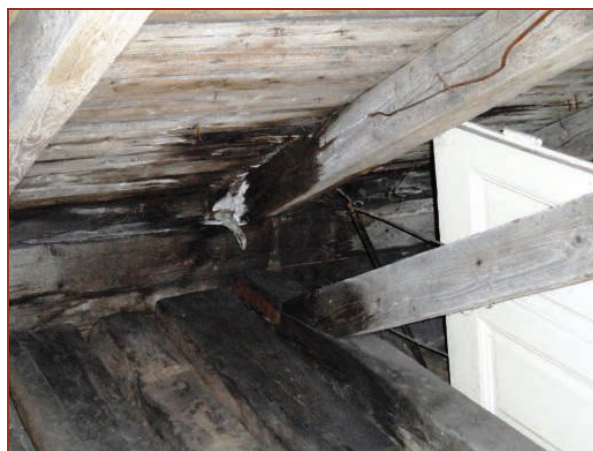
Fot. 50. Zagrybione elementy więźby dwuwieszakowego
