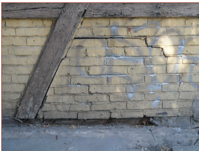
Fot. 55. Pęknięcia świadczące o osiadaniu fundamentu
