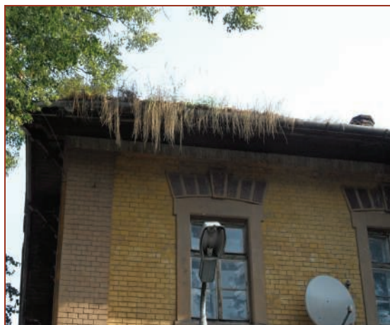
Fot. 74. Zarośnięta rynna na budynku piętrowym
