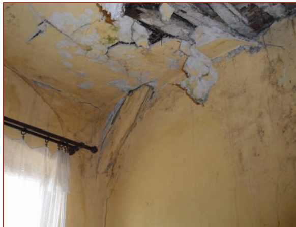
Fot. 77. Stan tynków w pomieszczeniu 2.3.
