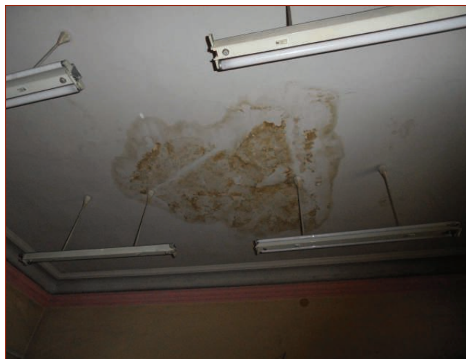
Fot. 73. Zawilgocony sufit w pomieszczeniu 1.3.
