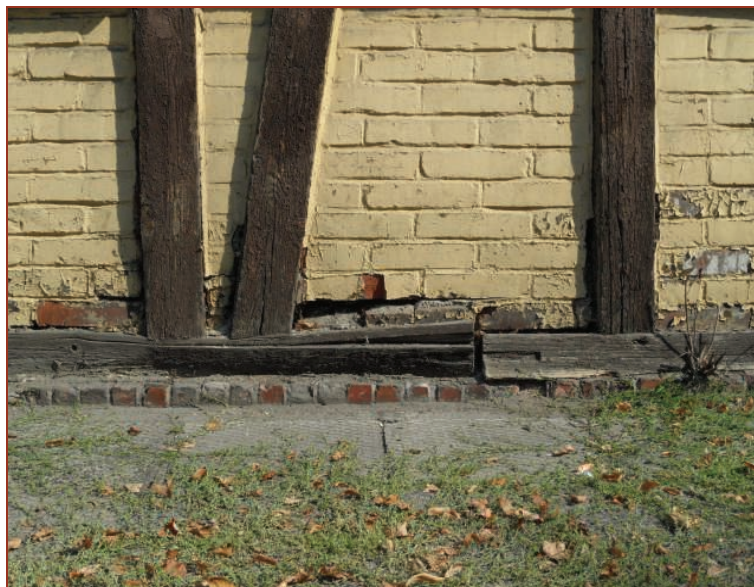
Fot. 54. Spróchniała podwalina oraz widoczne oznaki osiadania
