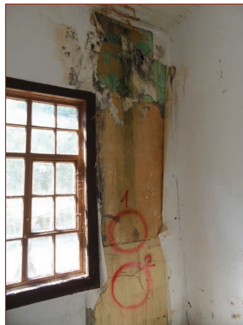
Fot. 60. Grzyb na ścianie w pom. nr 3.6
