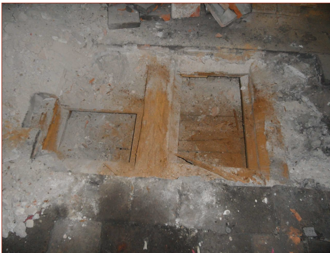
Fot. 11. Odkrywką stropu o rozpiętości 6,82 m nad piętnem
