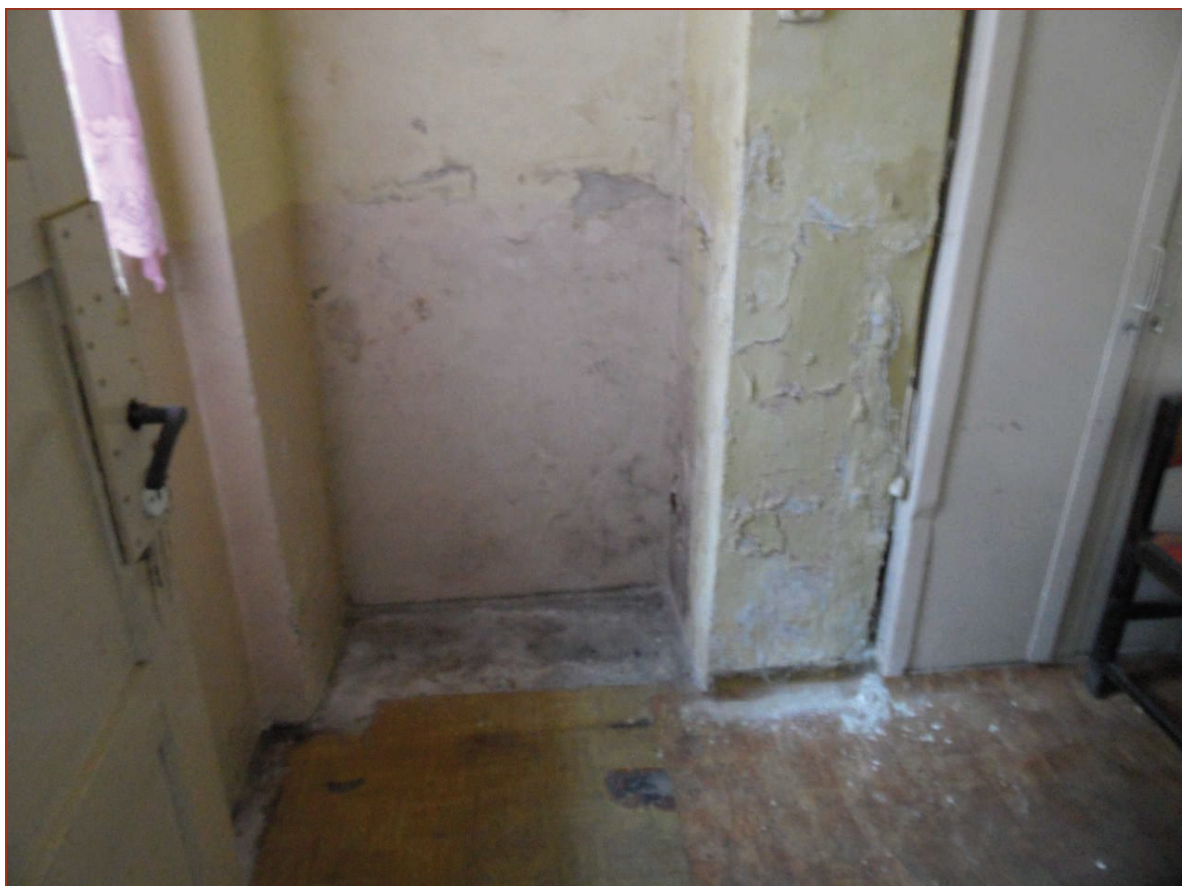
Fot. 69. Zawilgocona i zagrzybiona ściana w pomieszczeniu 4.7. budynku wc
