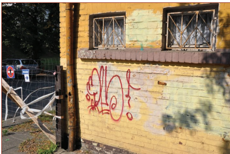
Fot. 83. Dziurawa rura spustowa w budynku wc
