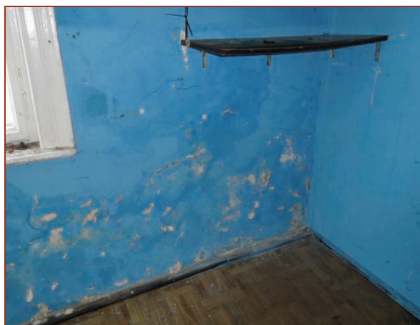
Fot. 70. Zawilgocona ściana w pomieszczeniu 1.7.
