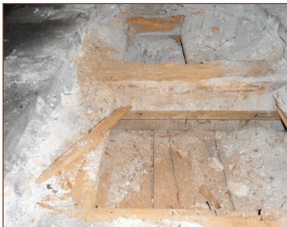
Fot. 43. Spróchniałe belki w stropie nad piętrem
