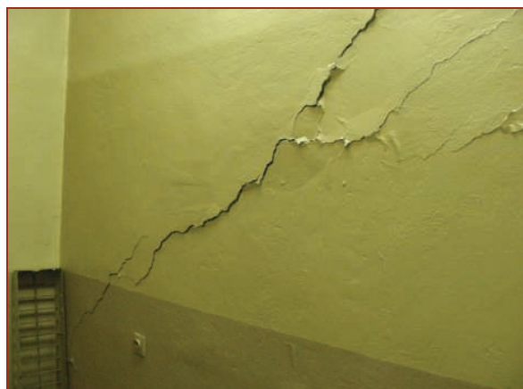
Fot.37. Pęknięcie ściany działowej widok z pomieszczenia 1.5.
