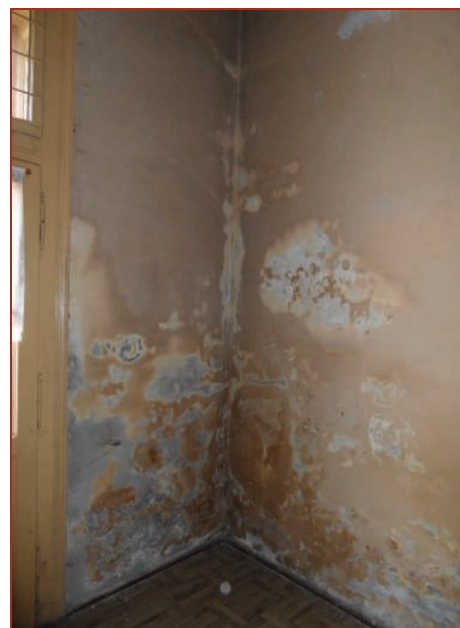
Fot. 41. Grzyb na ścianie w pomieszczeniu 1.2.
