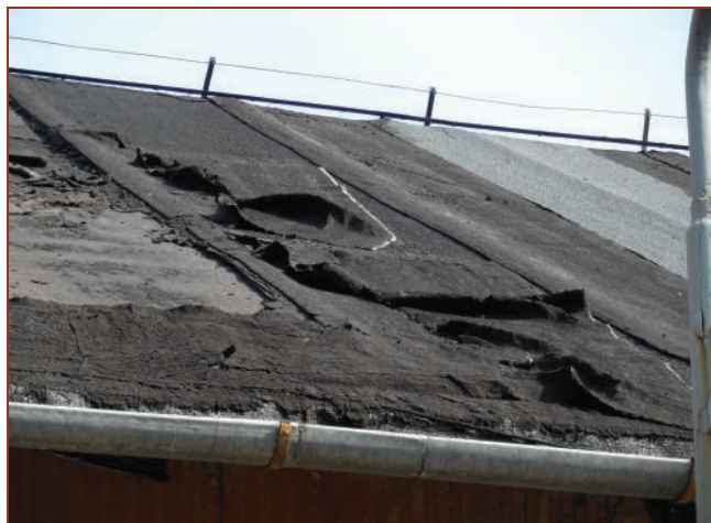
Fot. 79. Stan pokrycia dachowego w budynku parterowym
