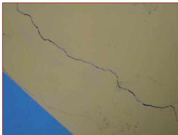
Fot. 38. Pęknięcie ściany działowej widok z pomieszczenia 1.7.
