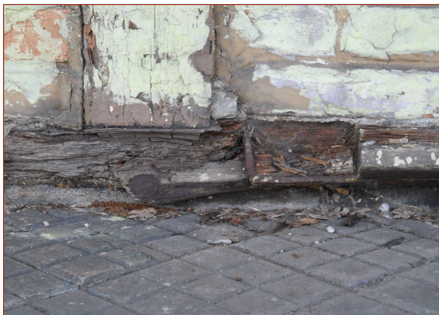
Fot. 53. Spróchniała podwalina i zapadnięty teren przy ścianie pod wiatą
