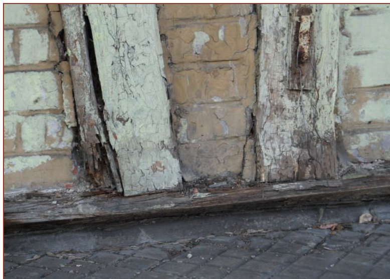
Fot. 56. Słup i zastrzał w rejonie podwaliny
