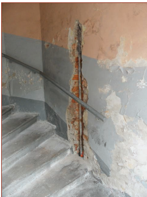
Fot. 72. Zawilgocona ściana klatki schodowej
