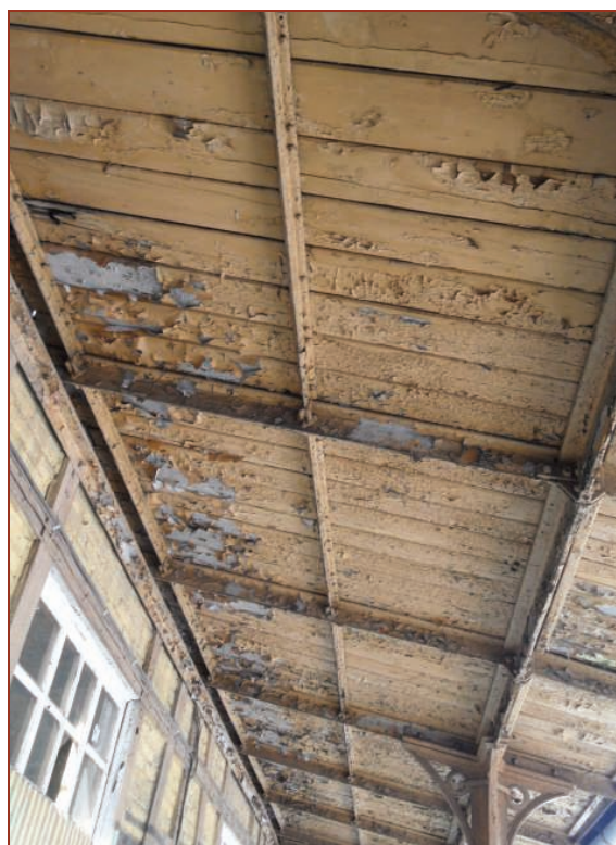
Fot. 65b. Skorodowane belki i płatwie.
