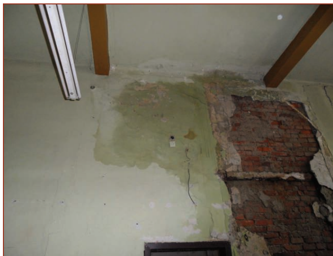
Fot. 59. Mokra ściana w pomieszczeniu 3.10.
