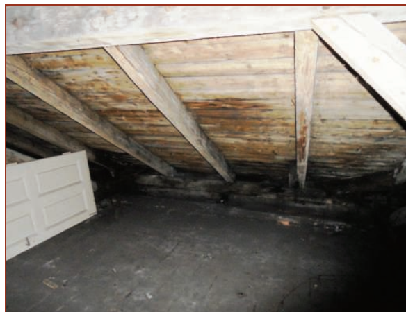
Fot. 49. Zamknięte i spróchniałe końcówki krokwii i przegniła murłata
