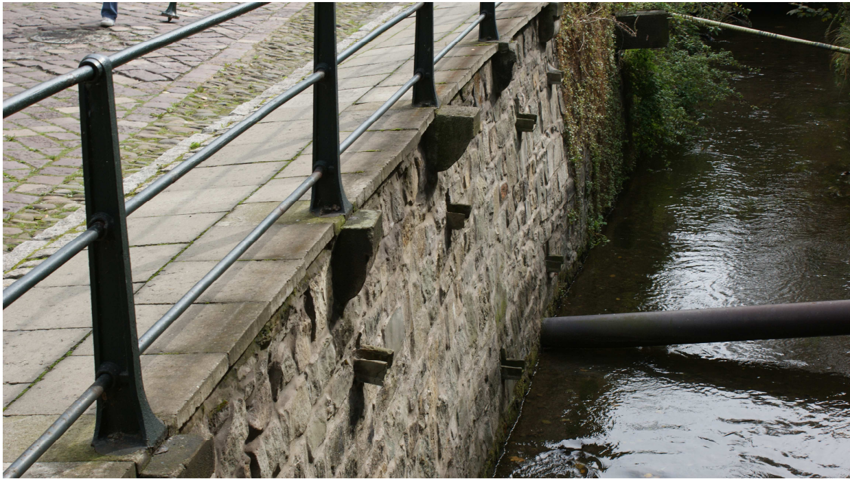
Fot. Odprowadzenie wód deszczowych z terenu utwardzonego za pomocą wpustów ulicznych i „rzygaczy kamiennych w obudowie kanału
