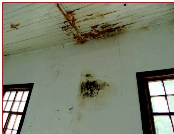
Fot. 78. Grzyb na ścianie w pomieszczeniu 3.6.
