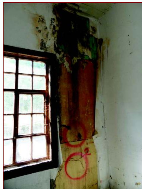
Fot. 60. Grzyb na ścianie w pom. nr 3.6
