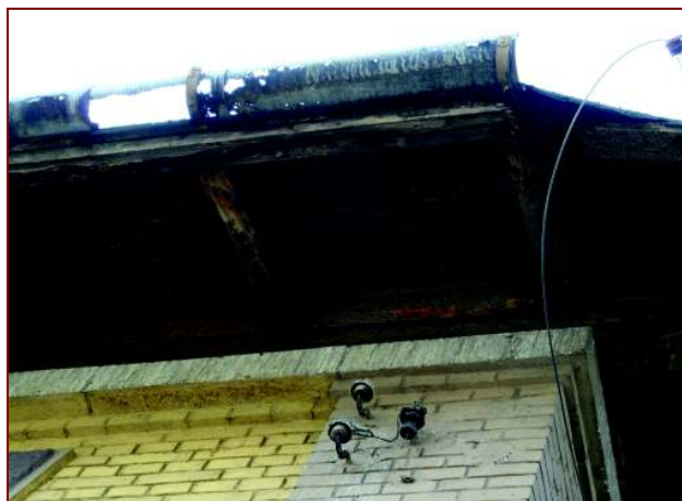
Fot. 75. Dziurawa rynna na budynku piętrowym
