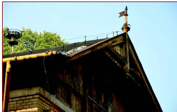
Fot. 47. Spróchniała i uszkodzona konstrukcja wieszarowa
