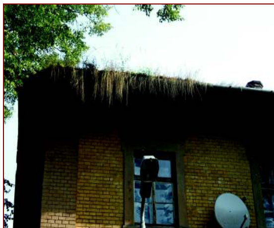
Fot. 74. Zarośnięta rynna na budynku piętrowym
