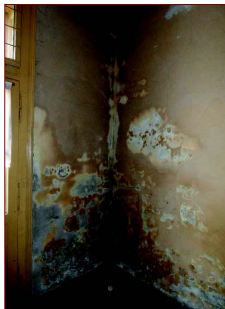
Fot. 41. Grzyb na ścianie w pomieszczeniu 1.2.
