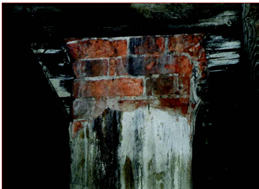
Fot. 76. Zamoczone i zagrzybione krokwie, deskowanie, odpadający tynk z komina to skutek oberwanej obróbki blacharskiej komina
