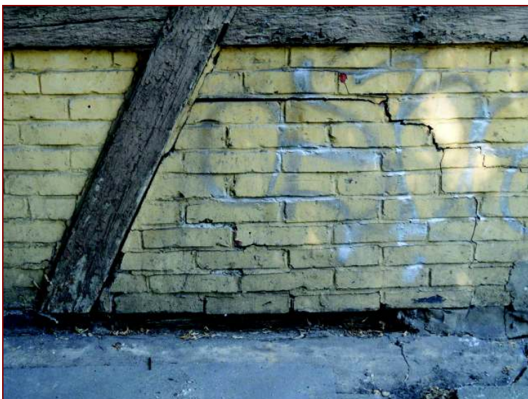
Fot. 55. Pęknięcia świadczące o osiadaniu fundamentu
