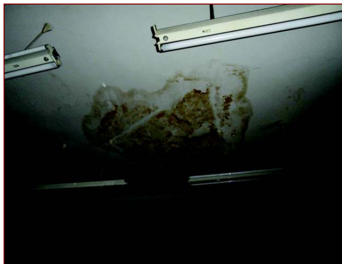
Fot. 73. Zawilgocony sufit w pomieszczeniu 1.3.
