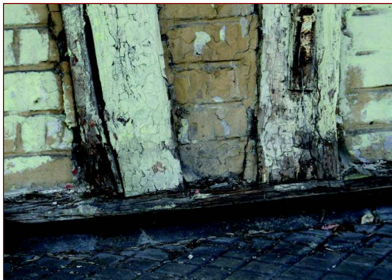
Fot. 56. Słup i zastrzał w rejonie podwaliny
