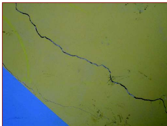
Fot. 38. Pęknięcie ściany działowej widok z pomieszczenia 1.7.
