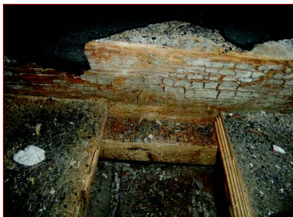
Fot. 42. Spróchniała belka w stropie nad parterem
