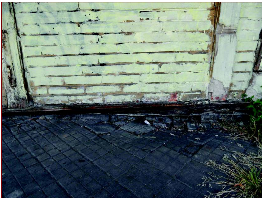
Fot. 52. Spróchniała podwalina i zapadnięty teren przy ścianie pod wiatą
