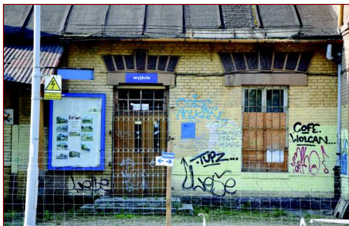
Fot.29. Drzwi hallu głównego i okno kasy w ścianie od strony peronów
