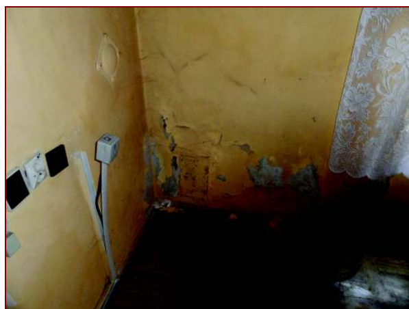
Fot. 71. Zawilgocona ściana w pomieszczeniu 1.1.
