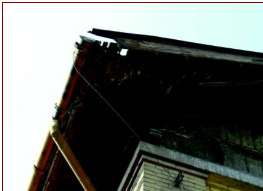
Fot. 46. Spróchniała krokiew czołowa i deskowanie
