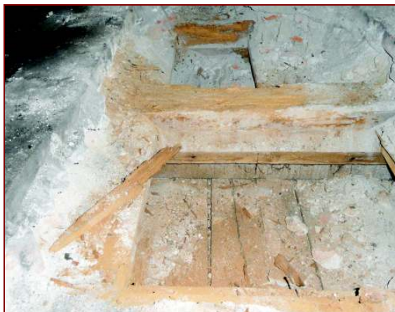
Fot. 43. Spróchniałe belki w stropie nad piętrem
