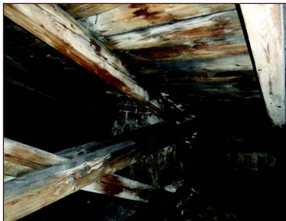
Fot. 51. Zagrybione elementy wężara jednowieszakowego
