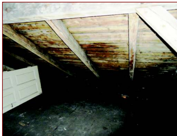
Fot. 49. Zamknięte i spróchniałe końcówki krokwie i przegnita murłata
