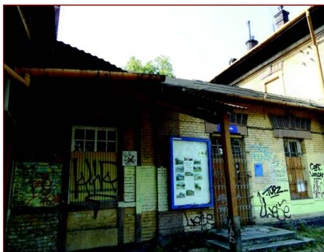
Fot. 66b. Przemieszczona i opadnięta belka nośna daszku
