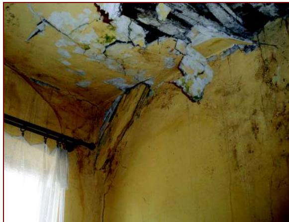
Fot. 77. Stan tynków w pomieszczeniu 2.3.
