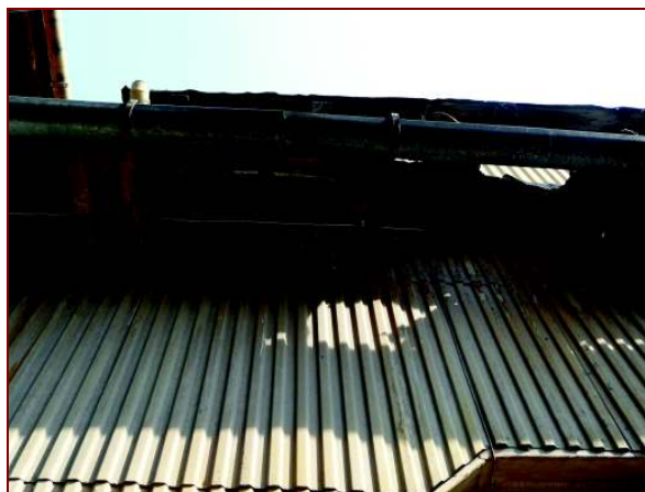
Fot. 81. Dziura w okapie nad wejściem do hallu główn.
