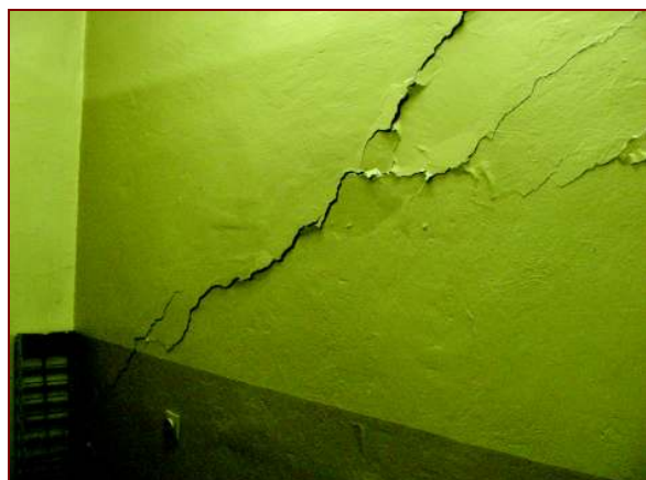
Fot.37. Pęknięcie ściany działowej widok z pomieszczenia 1.5.
