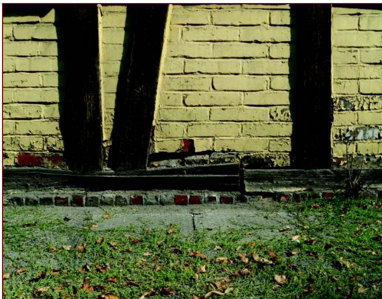
Fot. 54. Spróchniała podwalina oraz widoczne oznaki osiadania
