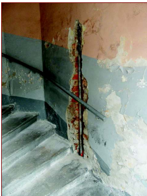
Fot. 72. Zawilgocona ściana klatki schodowej
