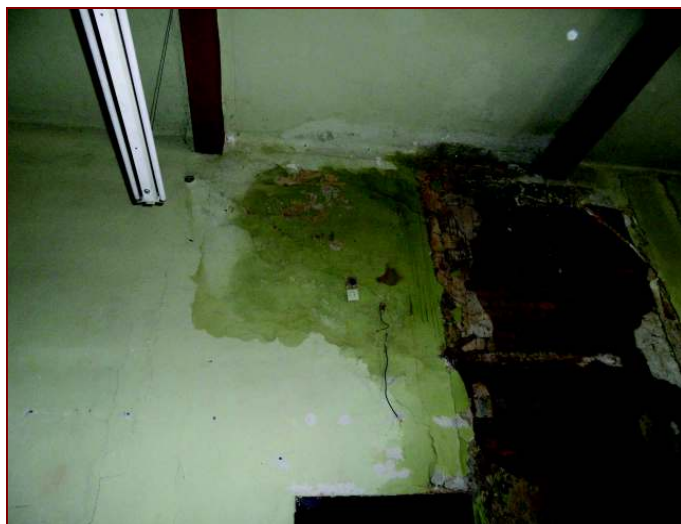
Fot. 59. Mokra ściana w pomieszczeniu 3.10.
