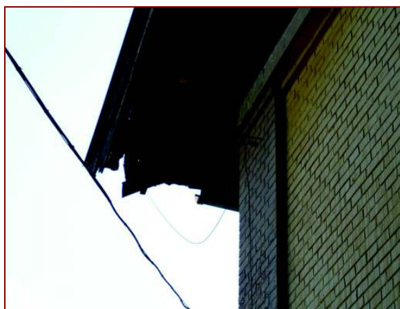
Fot. 44. Spróchniała krokiew czołowa, murłata oraz odpadające deskowanie
