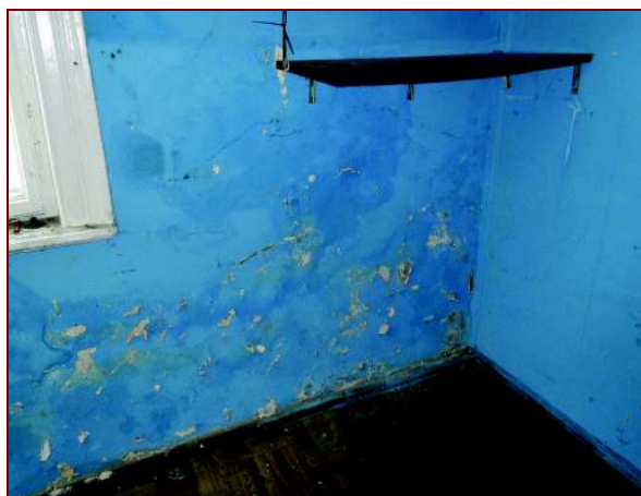
Fot. 70. Zawilgocona ściana w pomieszczeniu 1.7.
