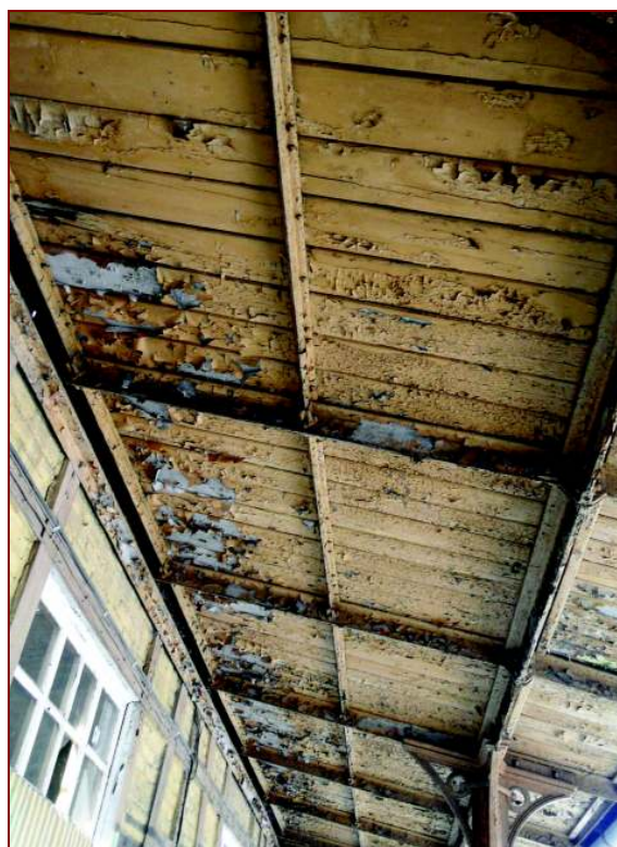
Fot. 65b. Skorodowane belki i płatwie.
