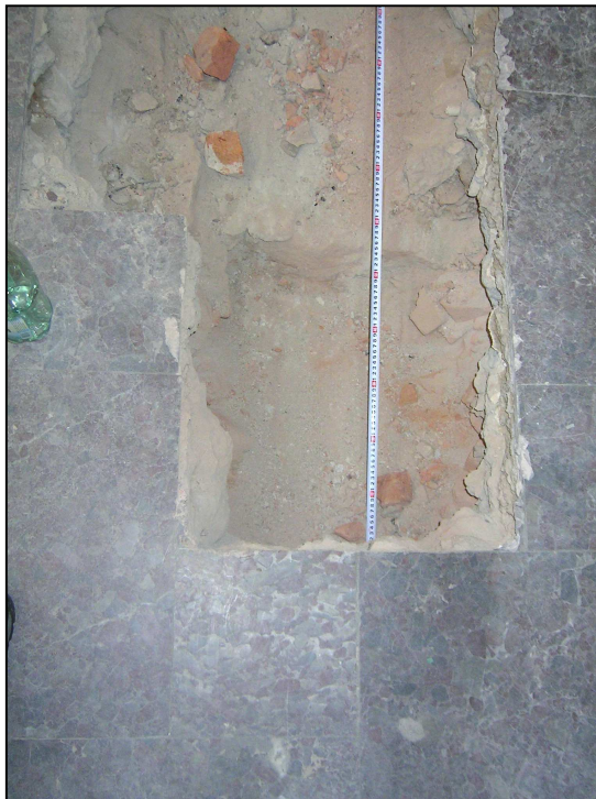
Zdj.3. ODK-2 -Rozmiary Odkrywki Sklepienia w najwyższym poziomie zwornika nad Piwnicą pom. P.2
