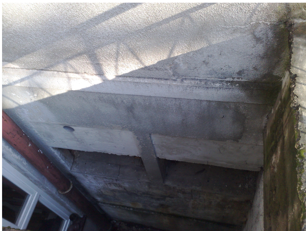
Zdj.: Fragment fosy ochronnej w sąsiedztwie wejścia głównego – widoczne zawilgocenia i wykwity solne oraz mech.
