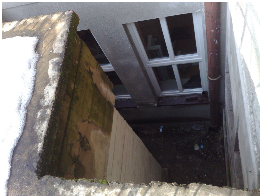
Zdj.: Fragment fosy ochronnej w sąsiedztwie wejścia głównego – widoczne zawilgocenia.
