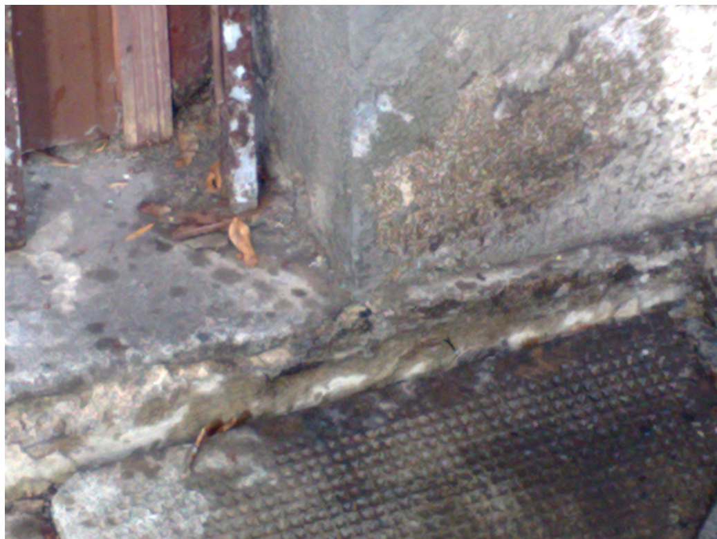
Zdj. Fragment południowej ściany – przy wejściu bocznym, nad pomieszczeniami kotłowni. Widoczna erozja ścian.
