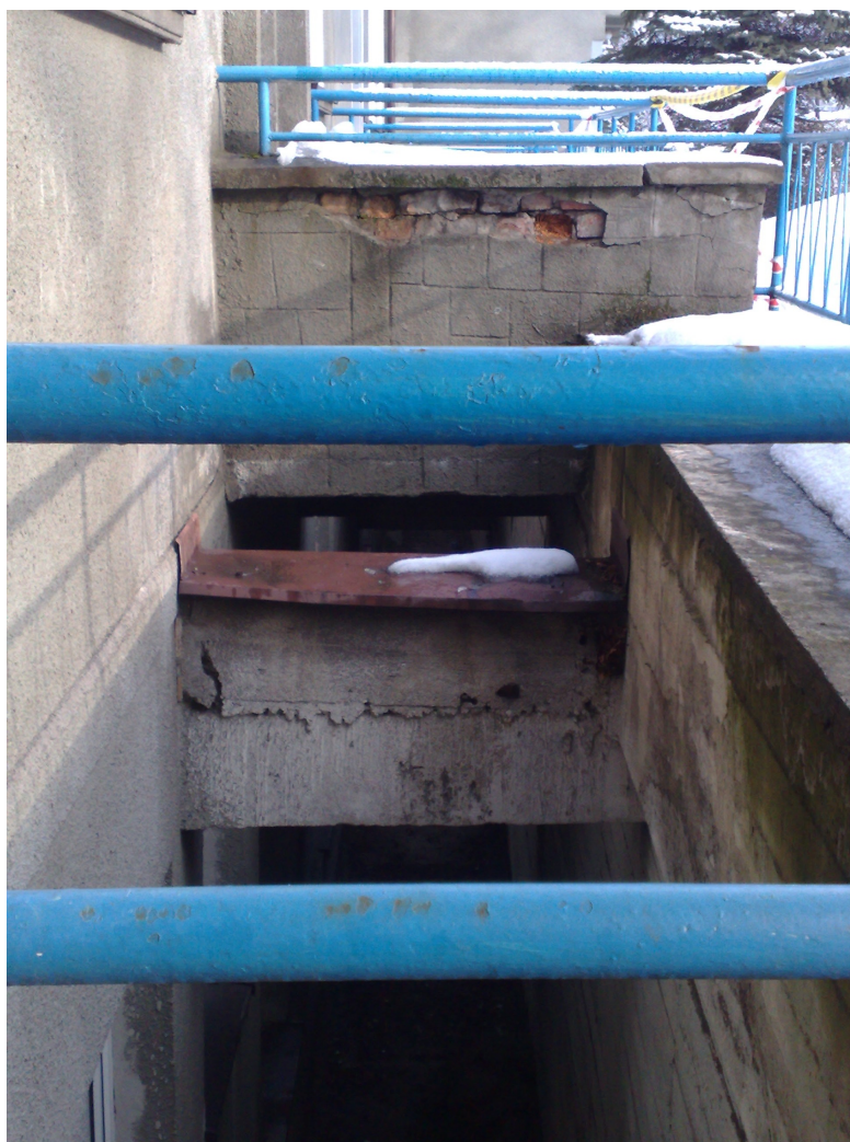
Zdj. Fragment fosi ochronnej, biegnącej wzdłuż budynku od strony ulicy. Widoczne zawilgocenia.
