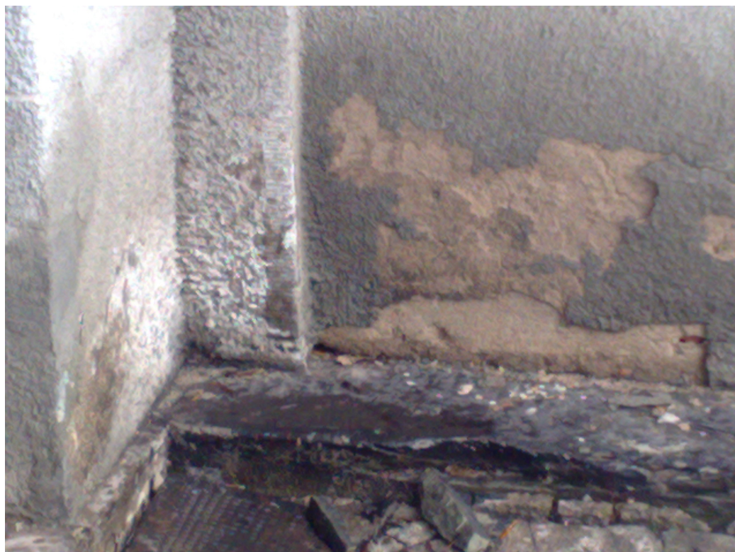
Zdj. Fragment południowego naroża ścian nad pomieszczeniami kotłowni. Widoczne wykwyty solne i zawilgocenia ścian oraz ich erozja.
