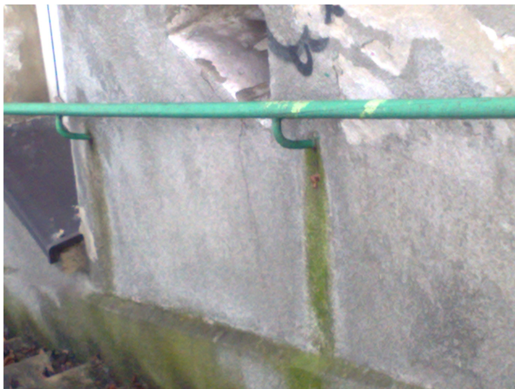
Zdj. Fragment ściany południowej w okolicy zejścia do pom. kotłowni. Widoczne zawilgocenia i omszenia ściany.
