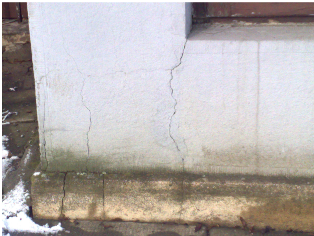
Zdj. Fragment naroża południowej ściany – nad pomieszczeniami kotłowni. Widoczne zawilgocenia i pęknięcia ściany.
