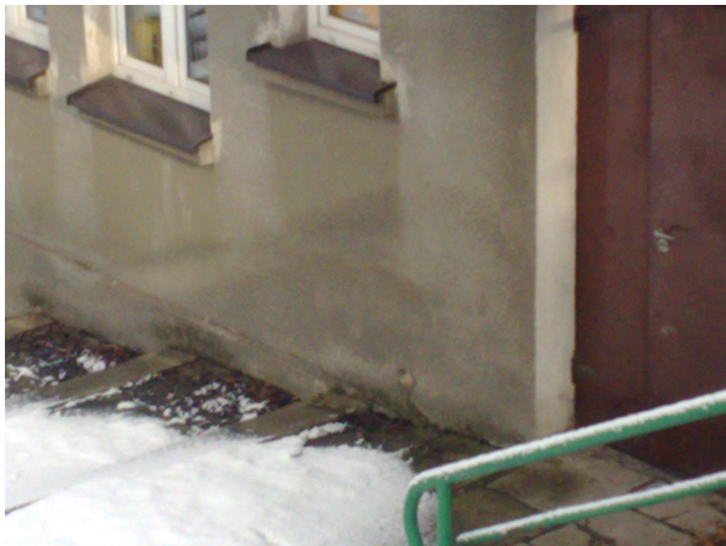
Zdj. Fragment ściany południowej w okolicy wejścia do pom. kotłowni. Widoczne zawilgocenia ściany.
