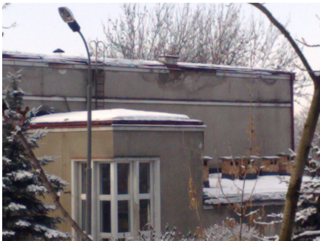
Zdj.: Zacieki na ścianie i ubytki tynków wzdłuż i pod gzymsem wieńczącym
