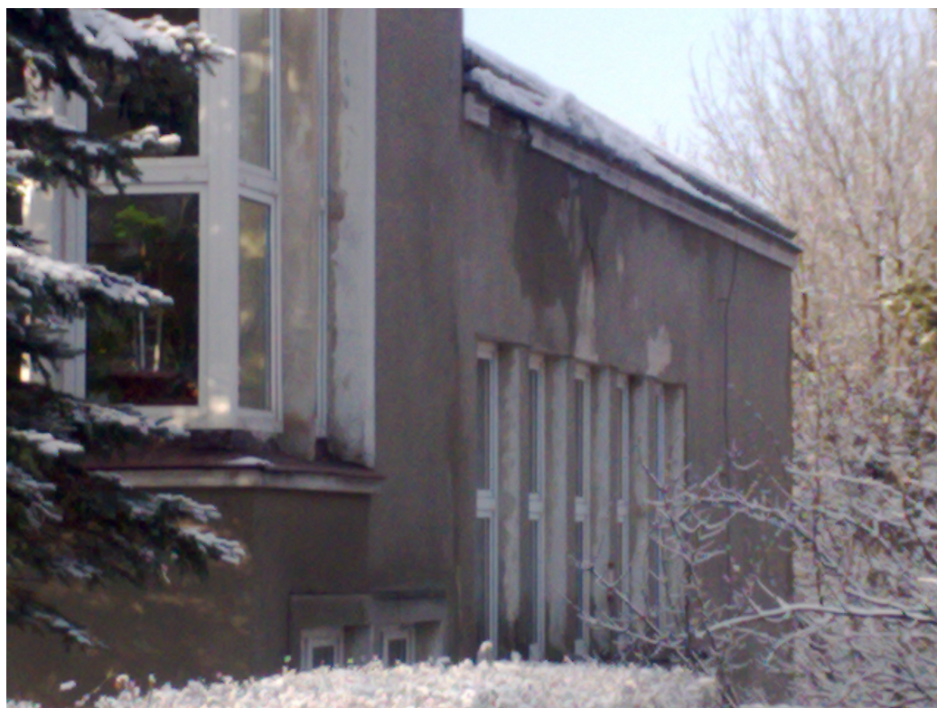
Zdj.: Zacieki na ścianie i ubytki gzymsu wieńczącego i tynków – efekt nieprawidłowych okuc blacharskich i orynnowania.
