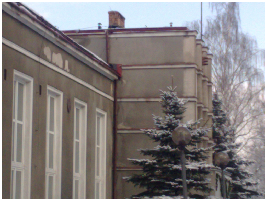
Zdj.: Fragment elewacji fontowej z widocznymi pasami gzymsów (do zachowania lub odtworzenia!) oraz znacznymi zawilgoceniami i ubytkami tynków.
