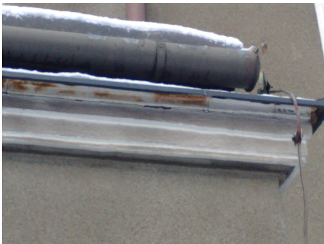
Zdj. Fragment elewacji budynku nad główną częścią noclegową – widoczne szczegóły opaskowych gzymsów wieńczących – do bezwzględnego odtworzenia.
