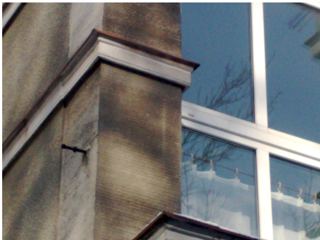
Zdj. Fragment naroża budynku w sąsiedztwie wejścia głównego – widoczne szczegóły opaskowego gzymsu pośredniego – do bezwzględного odtworzenia.
