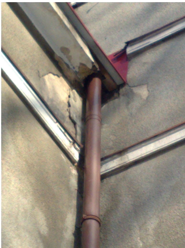
Zdj. Fragment naroża budynku w sąsiedztwie wejścia głównego – widoczne zawilgocenia oraz ubytki tynków. Na uwagę zasługują tu gzymsy opaskowe i wieńczący ścianę – do bezwzględnego zachowania lub odtworzenia.
