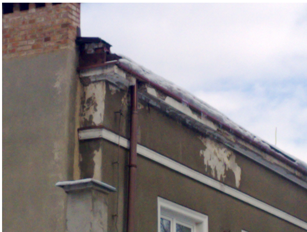
Zdj.: Widoczne ubytki tynku.
