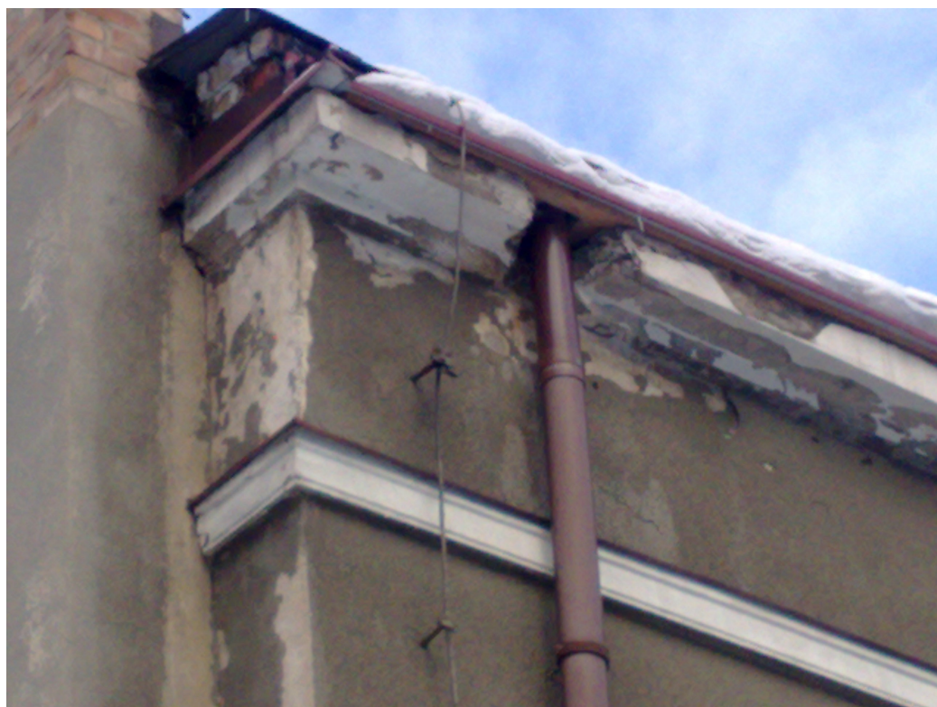
Zdj.: Detal – gzyso opaskowy i wieńczący ścianę. Widoczna dewastacja gzyso na
