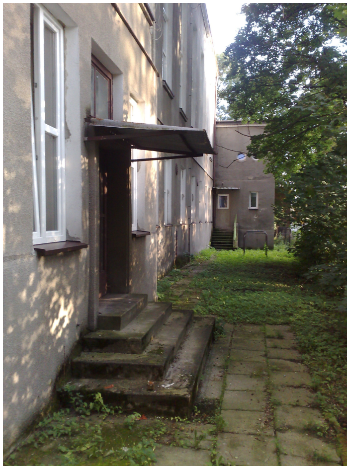
Zdj Fragment elewacji zachodniej budynku z wejściem bocznym – widoczne istniejące zadaszenie nad drzwiami – do wymiany.
