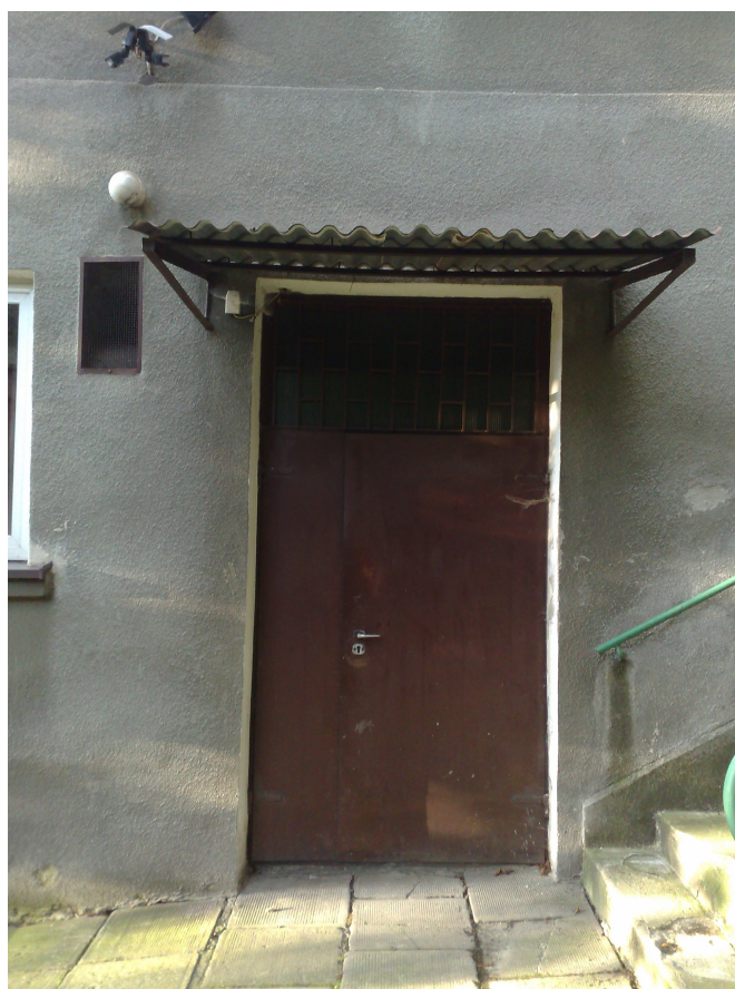
Zdj. Wejście do kotłowni – widoczne istniejące zadaszenie nad drzwiami – do wymiany.
