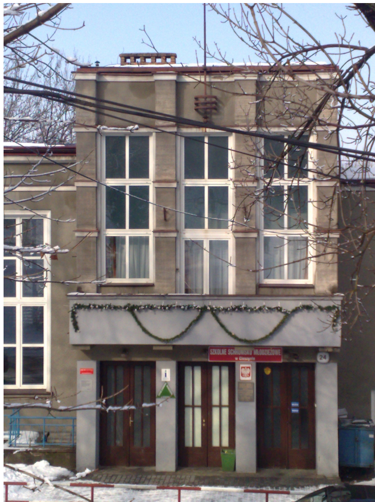
Zdj. Fragment elewacji budynku z wejściem głównym – widoczne główne drzwi wejściowe – do wymiany. Należy zachować istniejącą symetrię elewacji.
