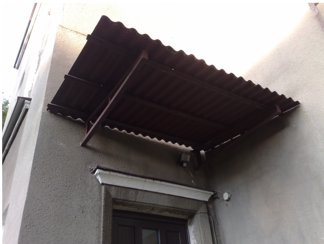
Zdj Fragment południowo-zachodniego naroża budynku z wejściem bocznym – widoczne istniejące zadaszenie nad drzwiami – do wymiany.
