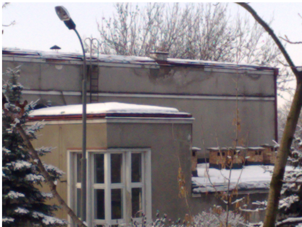
Zdj.: Północna część budynku – widoczne dachy kryte skorodowaną blachą. Nad częścią wejściową i główną klatką schodową.
