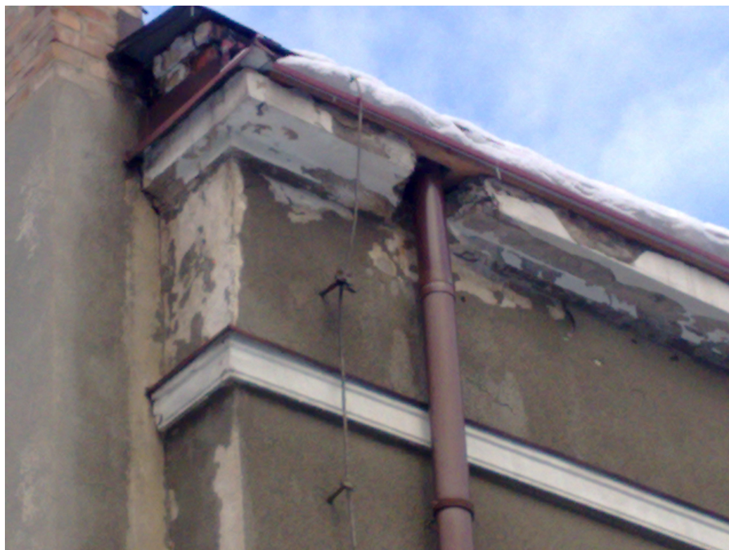
Zdj.: Południowo-wschodnie naroże budynku. Widoczna dewastacja naroża połączenia dachowej i gzymsu wieńczącego (dachowego) nad wielofunkcyjną salą widowiskowo-rekreacyjną.
