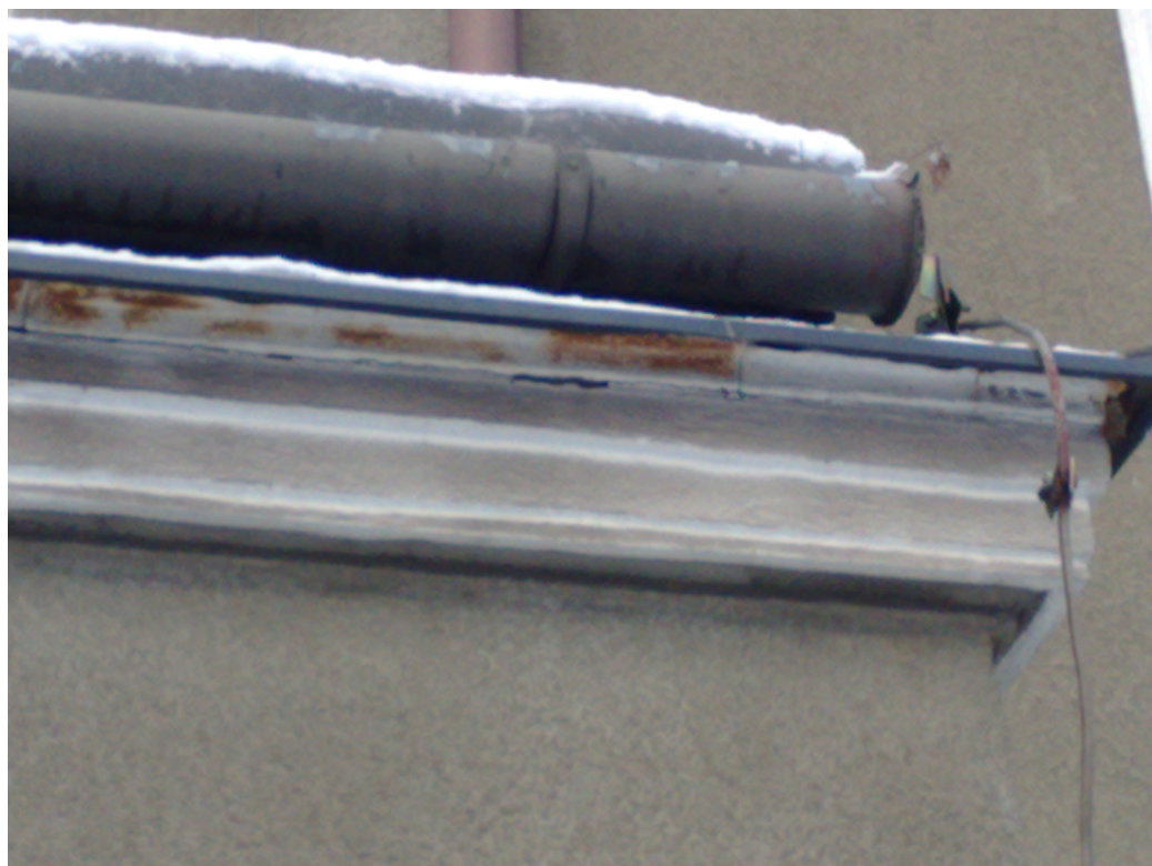
Zdj. Fragment elewacji budynku nad główną częścią noclegową – widoczne szczegóły gzymsów wieńczących ( do bezwzględneho odtworzenia) oraz orywnowania i okuć.
