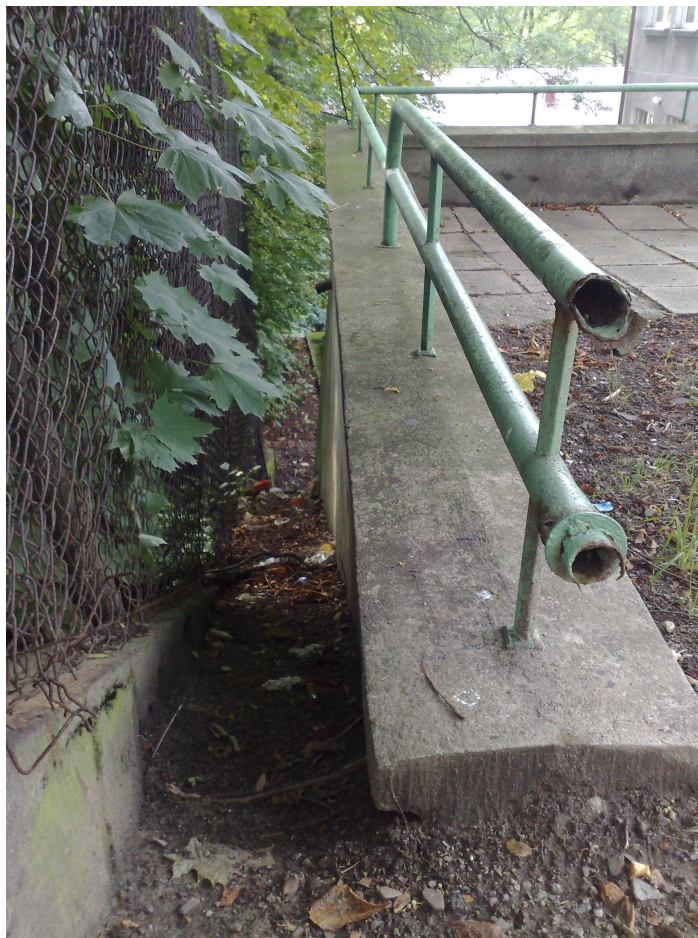
Fot.: Widok boku ściany oporowej od strony ulicy Błogockiej – widoczna przestrzeń (ok.55 cm) między ogrodzeniem (w granicy działki), a bokiem ściany.
