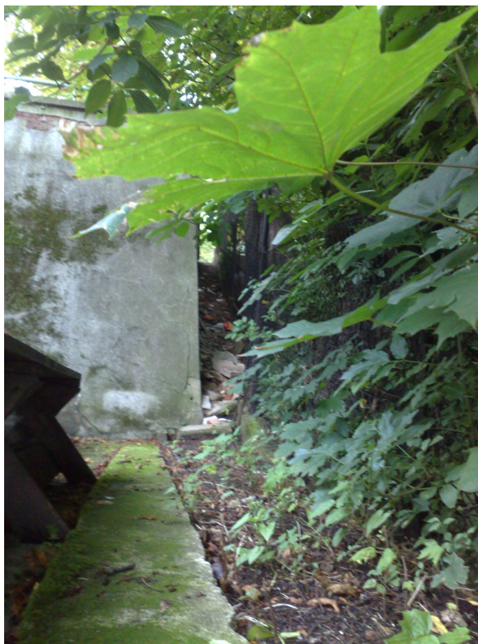
Fot.: Widok boku ściany oporowej od strony ogrodu – widoczna przestrzeń (ok. 55 cm) między ogrodzeniem, a bokiem ściany.
