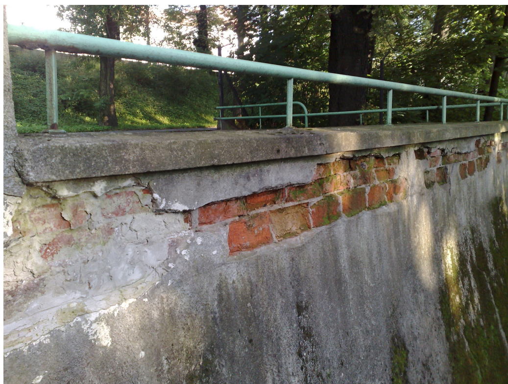
Fot. Widok ściany oporowej od strony ogrodu – widoczna erozja części górnej ściany.
