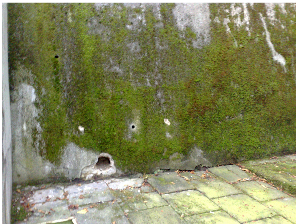
Fot. Widok ściany oporowej od strony ogrodu – widoczna erozja części dolnej ściany.
