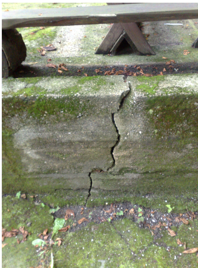
Fot. Fragment miejsca do siedzenia od strony południowej budynku – widoczna erozja murka.
