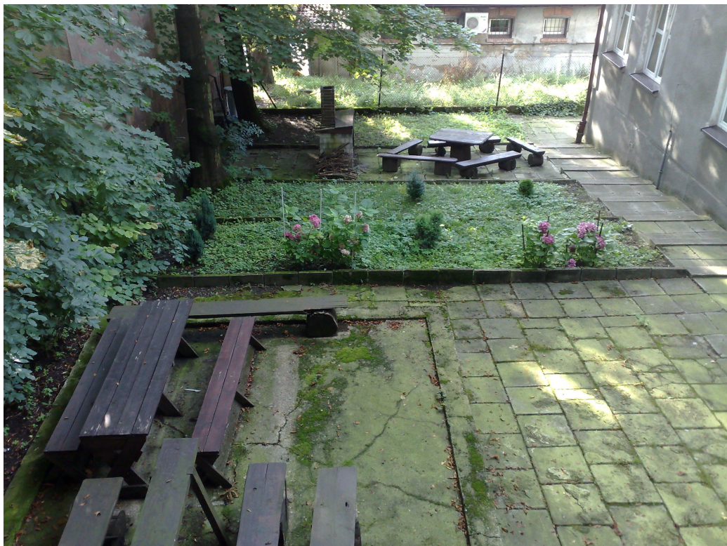
Fot. Fragment placów rekreacyjnych od strony południowej budynku – widoczna erozja nawierzchni.
