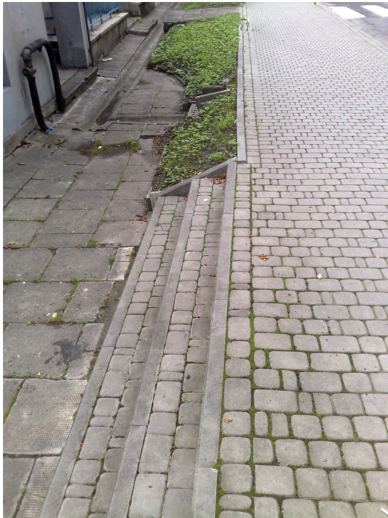
Fot. Fragment chodnika od strony ulicy – widoczne stare części nawierzchni od strony frontowej budynku
