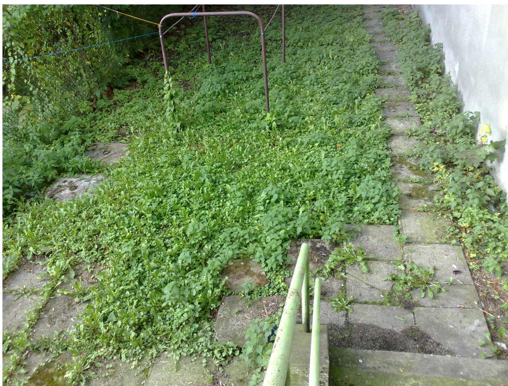
Fot. Fragment placu rekreacyjnego od strony zachodniej budynku – widoczna erozja nawierzchni i chodnika.
