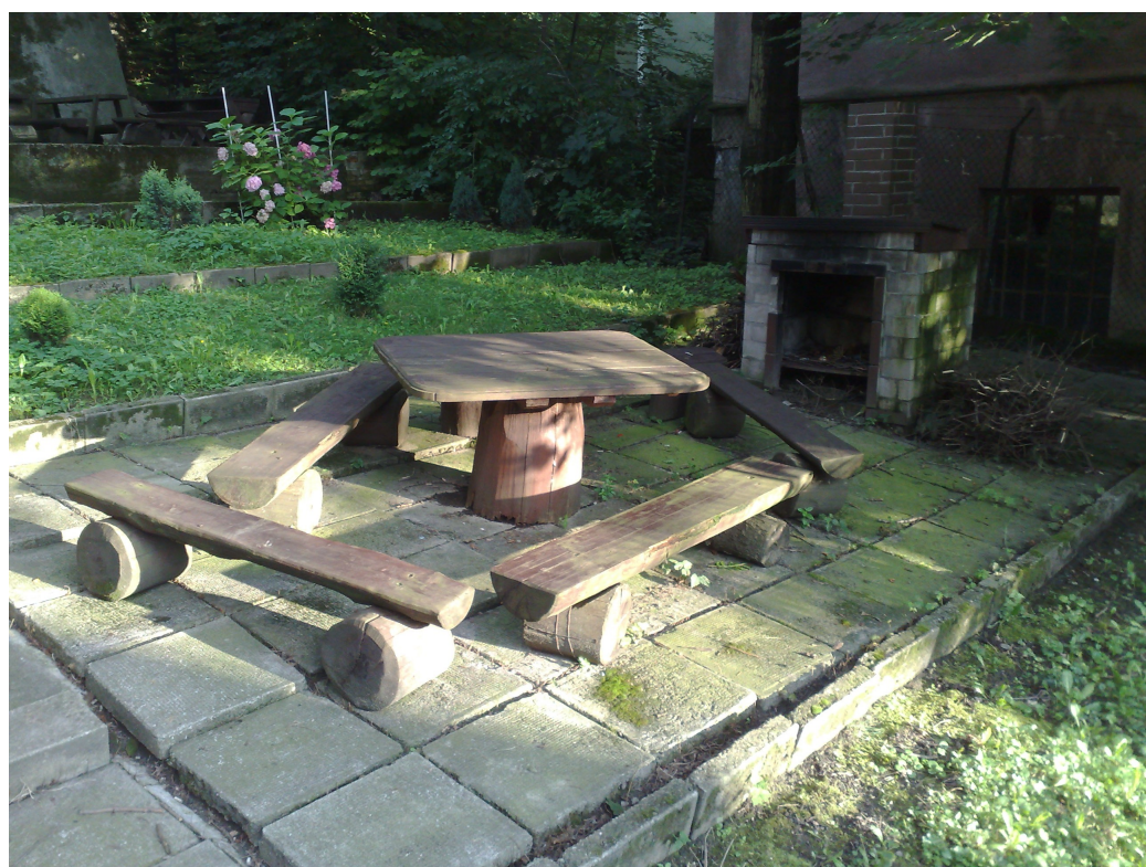
Fot. Fragment miejsca do grilowania od strony południowej budynku – widoczna erozja nawierzchni.
