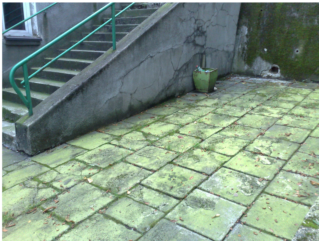
Fot. Fragment placu rekreacyjnego od strony południowej budynku – widoczna erozja nawierzchni i murów.
