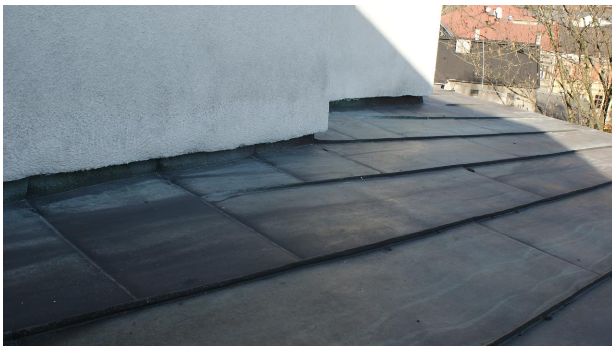
Zdjęcie nr 10 – za małe obróbki elementów pionowych, wykonane jako samodzielne
