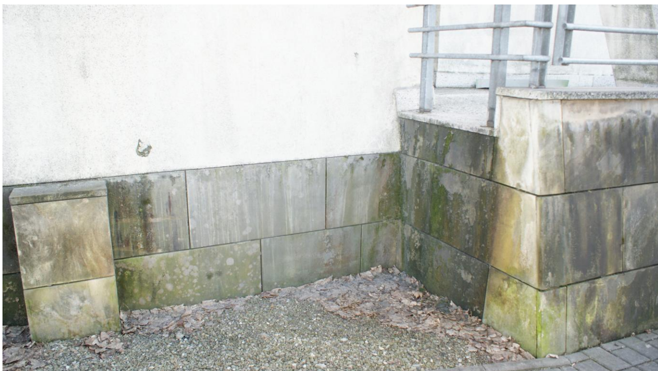
Zdjęcie nr 39 – zawilgocone płyty kamienne cokolu /przykład podciągania kapilarnej wody z gruntowej /
