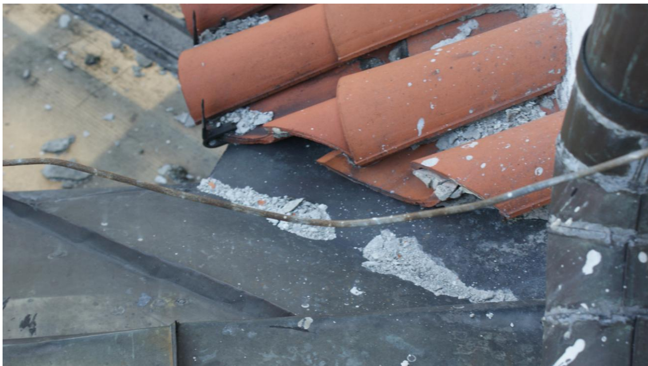
Zdjęcie nr 26 – luszcząca się zaprawa pod dachówkami
