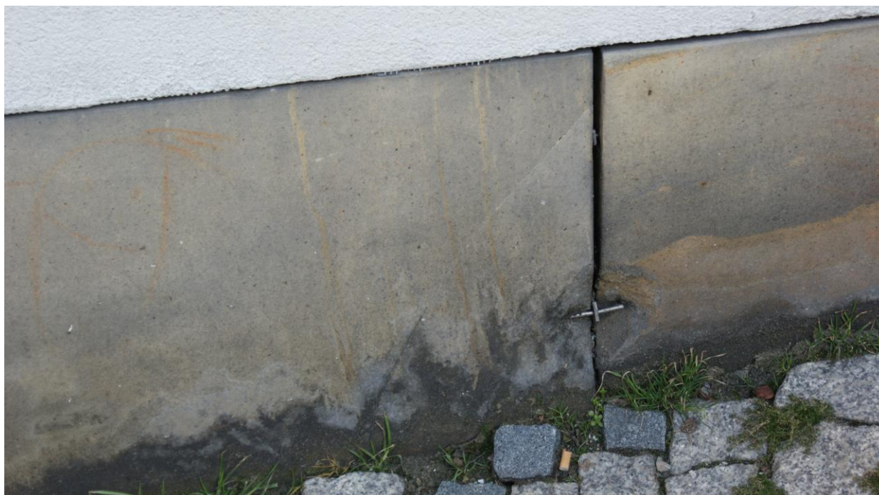
Zdjęcie nr 31-brak listwy startowej z okapnikiem na styku kamienia i tynku ceramicznego
