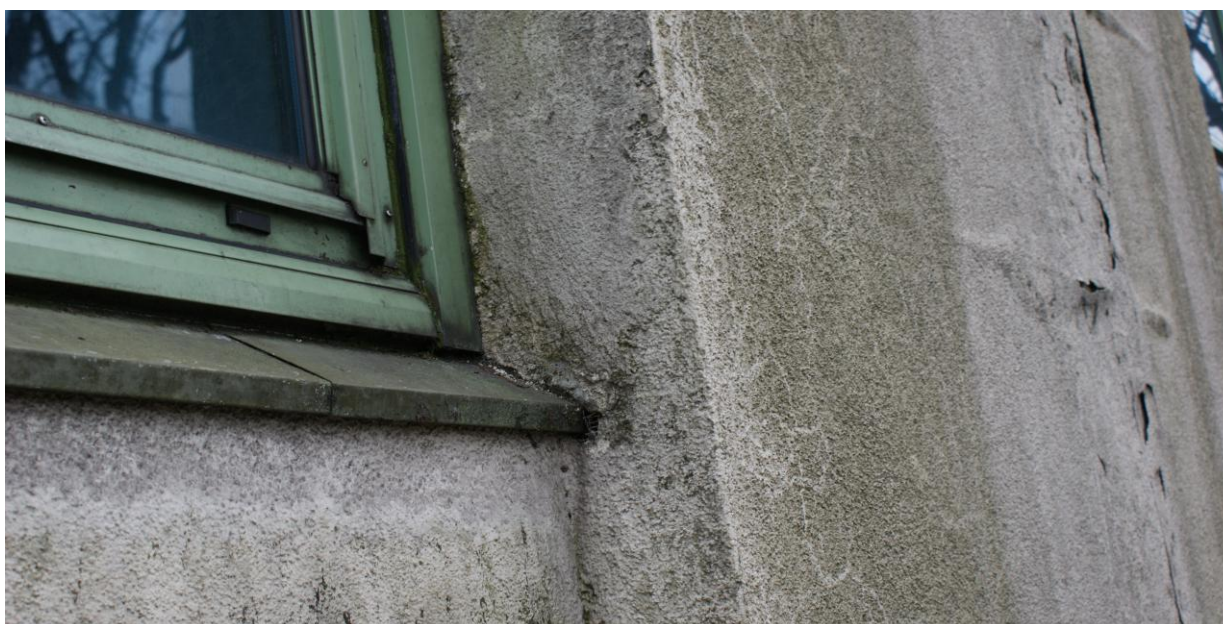
Zdjęcie nr 35- za krótkie parapety zewnętrzne
