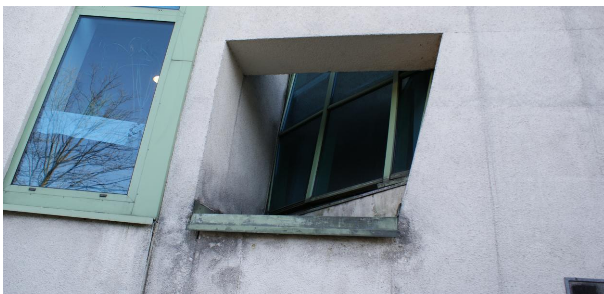
Zdjęcie nr 34 – niewłaściwe wymiary i wykonanie obróbek blacharskich
