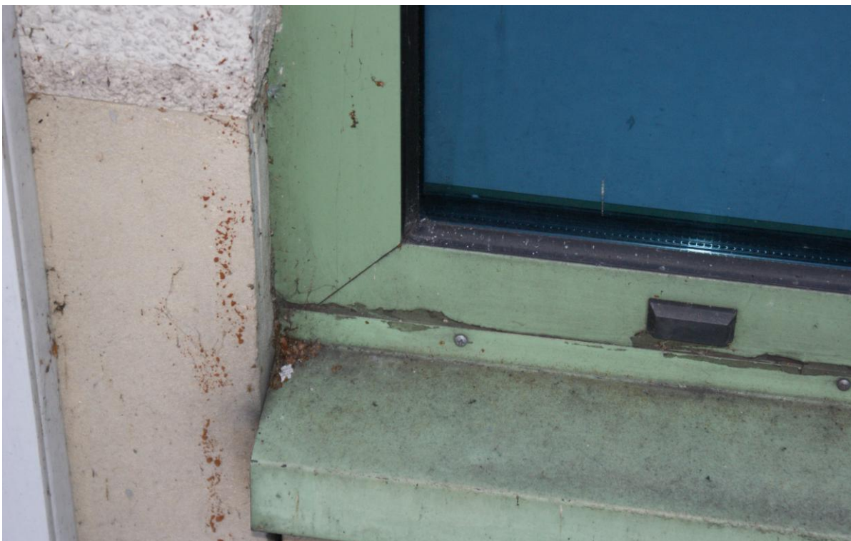
Zdjęcie nr 33- brak listwy dylatacyjnej i wykańczającej na styku kamień –tynk ceramiczny
