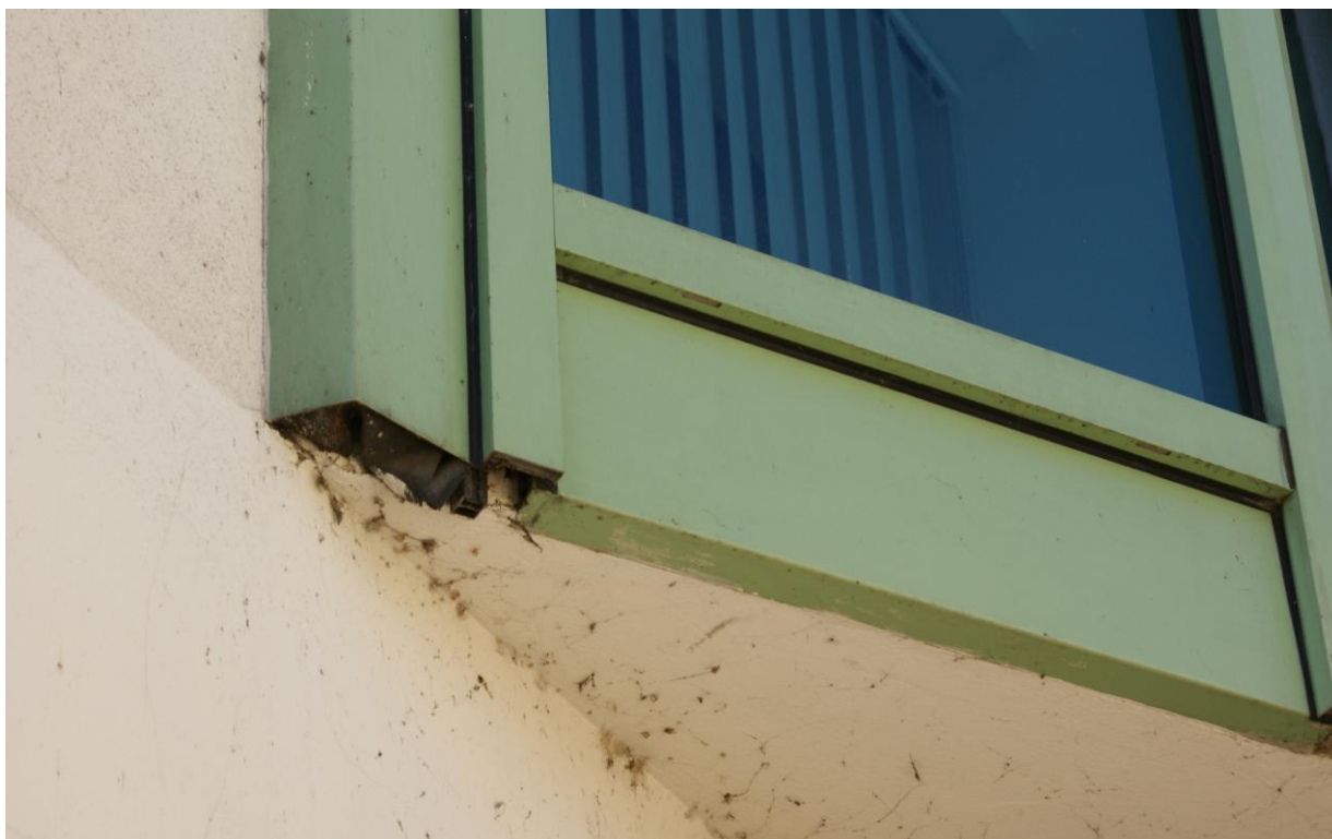
Zdjęcie nr 52 – przykład braku elementów wykończenia ścian kurtynowych
