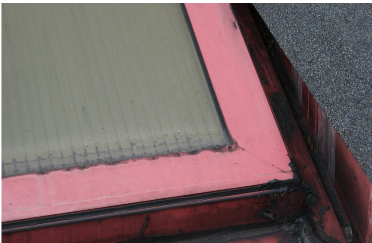
Zdjęcie nr 49 – światlik dachowy uszczelnienie przecieków
