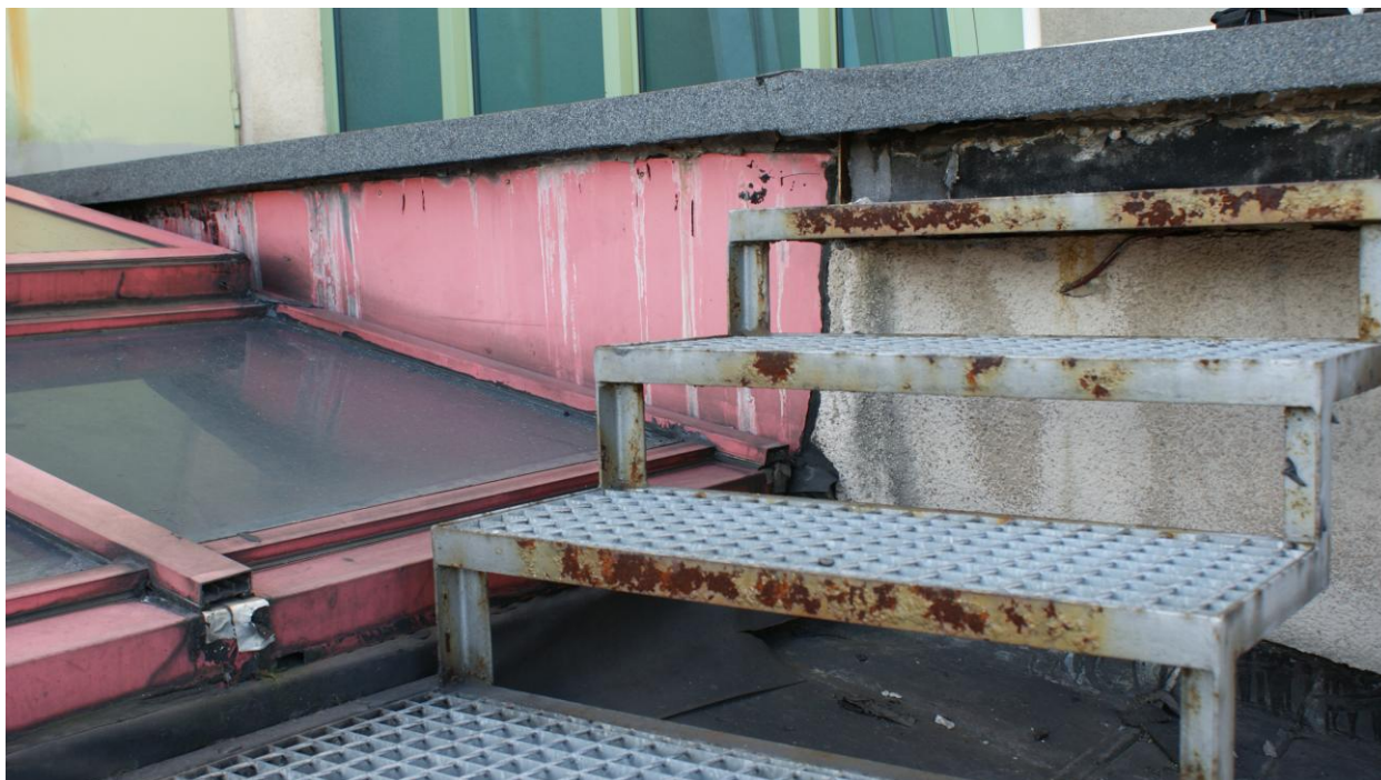
Zdjęcie nr 20- stan techniczny obróbki świetlika przy wejściu do wentylatorowni
