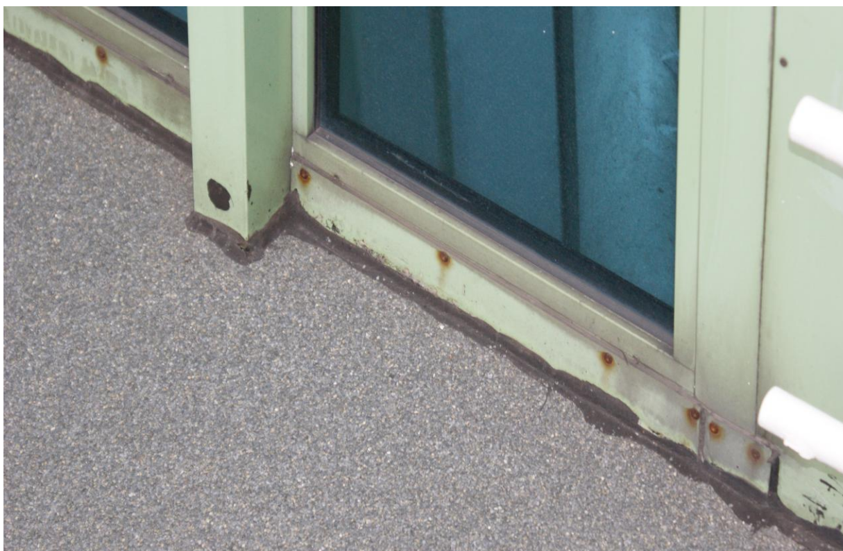
Zdjęcie nr 53 – przykład złej obróbki , która powoduje że woda opadowa spływająca po ścianie kurtynowej wpływa pod warstwę stropodachu
