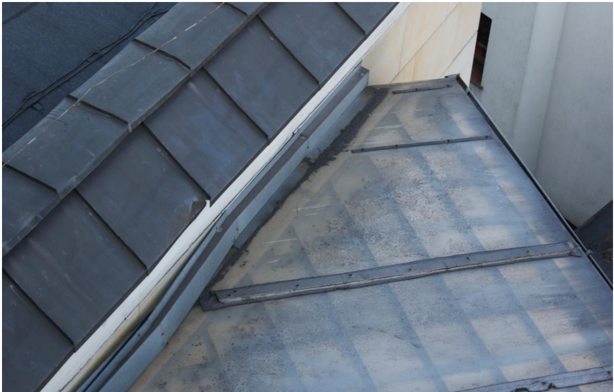
Zdjęcie nr 61 – widok zniszczonej obróbki blacharskiej pokrycia daszku i ściany attykowej
