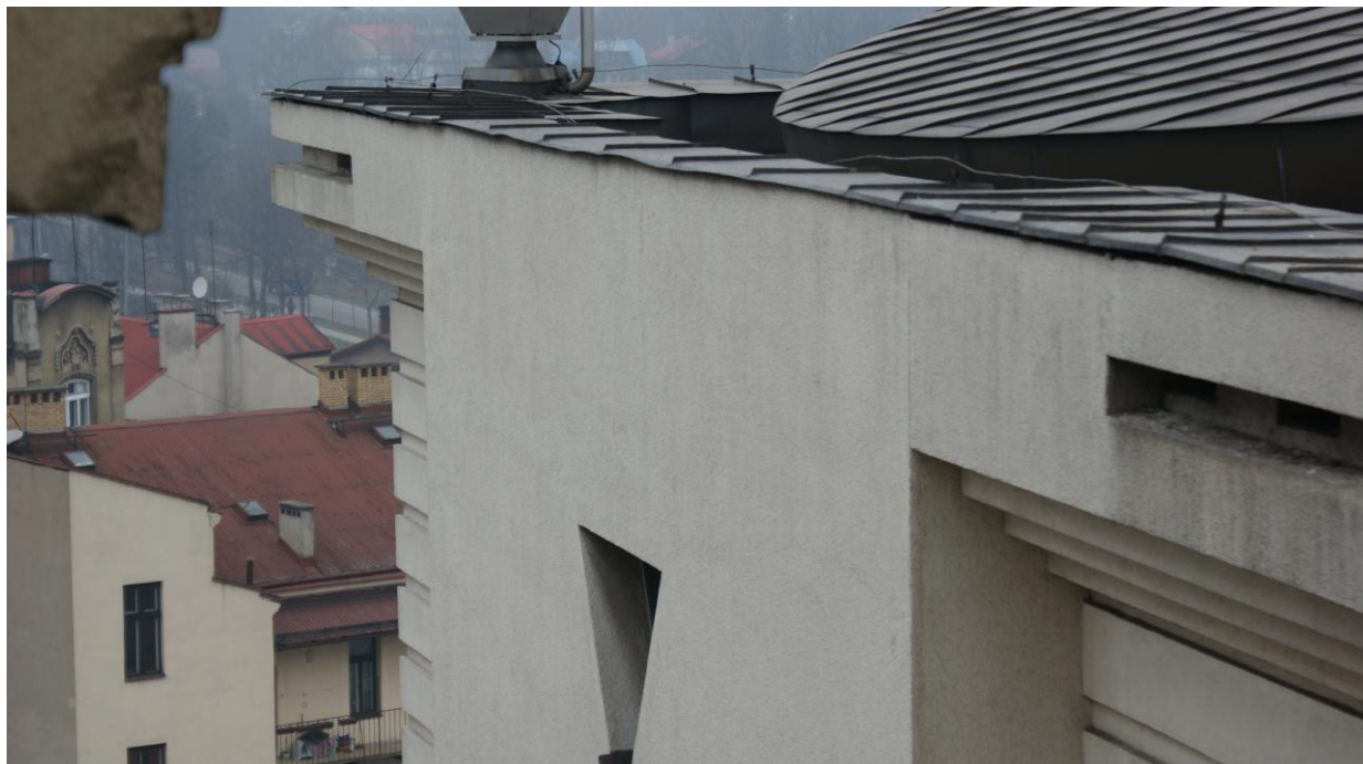
Zdjęcie nr 12- pogięte obróbki ścian attykowych , zły spadek obróbek
