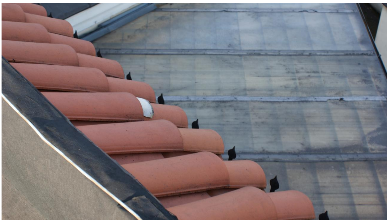
Zdjęcie nr 27 - wypadająca zaprawa z pod dachówek
