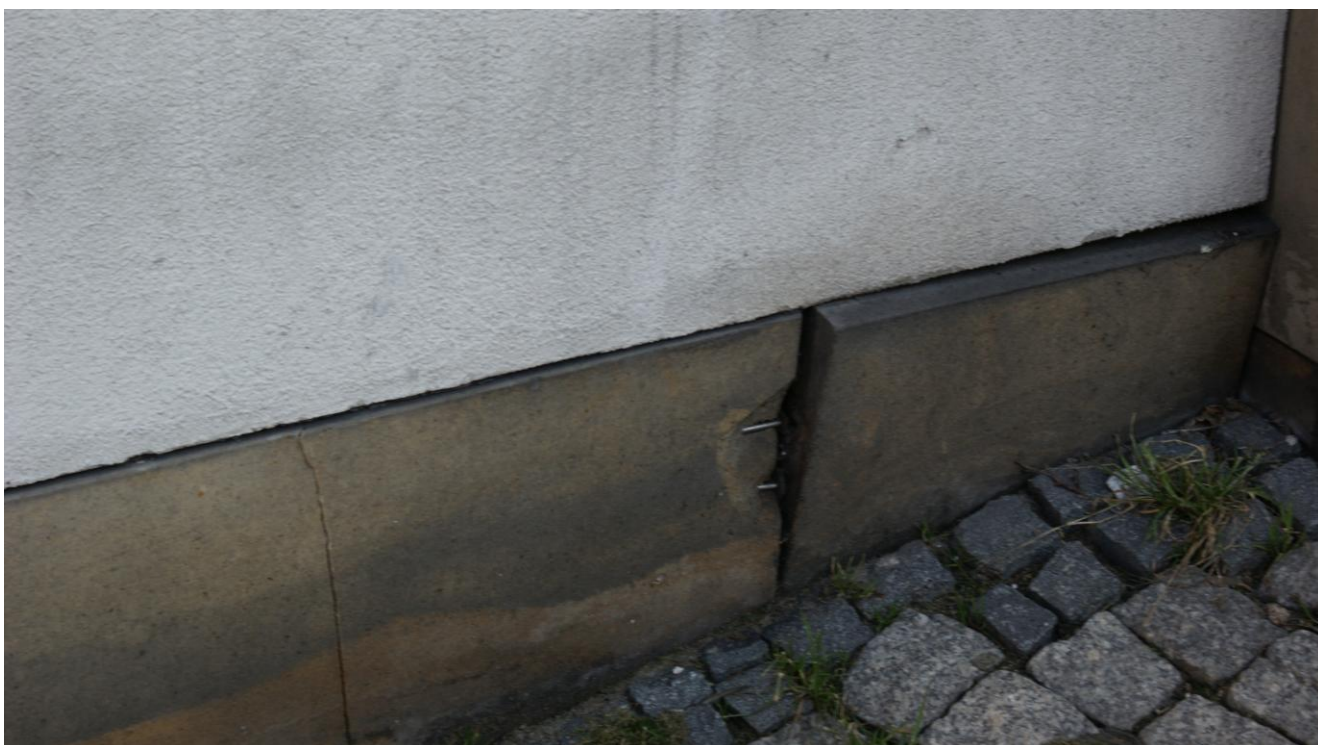
Zdjęcie nr 38 – wysadzone płyty kamienne przez nawierzchnię z kostki brukowej
