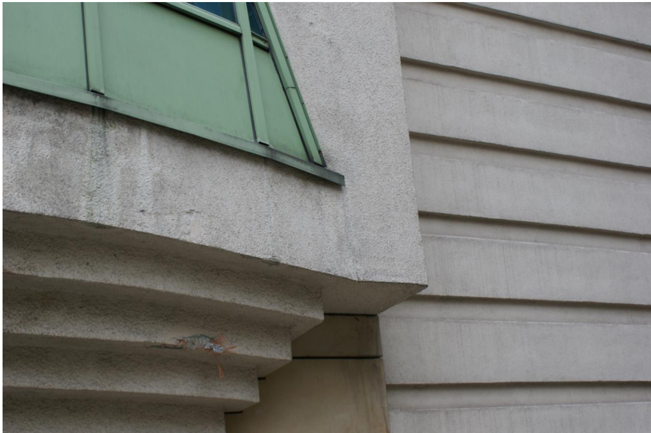
Zdjęcie nr 29 – przykład miejsca gdzie powinny być zamocowane listwy startowe z okapnikiem
