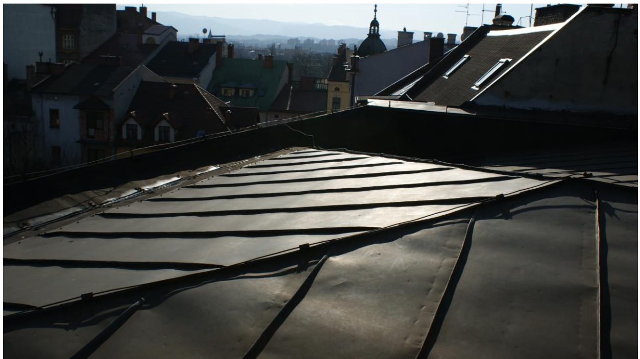
Zdjęcie nr 19 – widoczne pofałdowanie powierzchni blach , niewłaściwe zamocowanie do podłoża, za źle wykonany rąbek stojący uniemożliwiający ruchy termiczne blachy powodujący jej falowanie. Rąbek powinien być wykonany na spinkach lub łapkach przesuwnych
