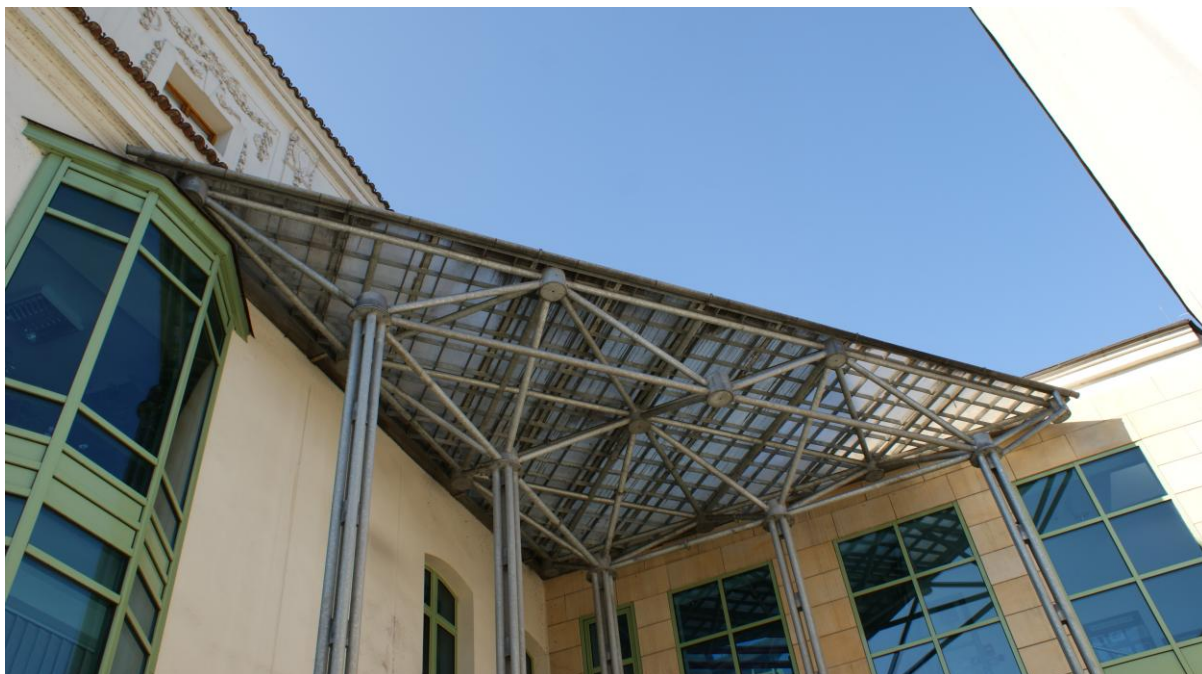
Zdjęcie nr 59- widok stanu technicznego konstrukcji daszku nad wejściem.
