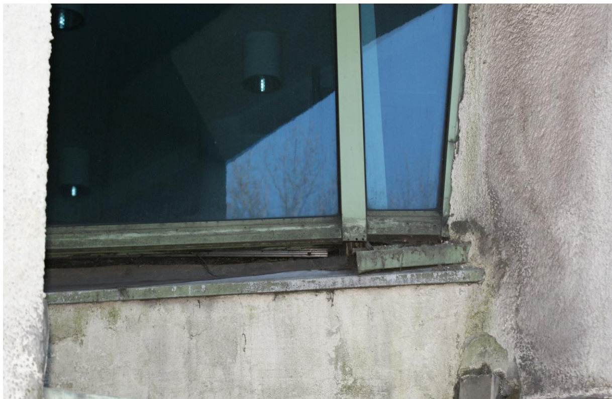
Zdjęcie nr 54- przykład niewłaściwego wykonania parapetu z obróbką blacharską
