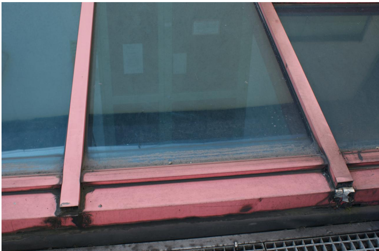
Zdjęcie nr 47 - brak elementów wykańczających
