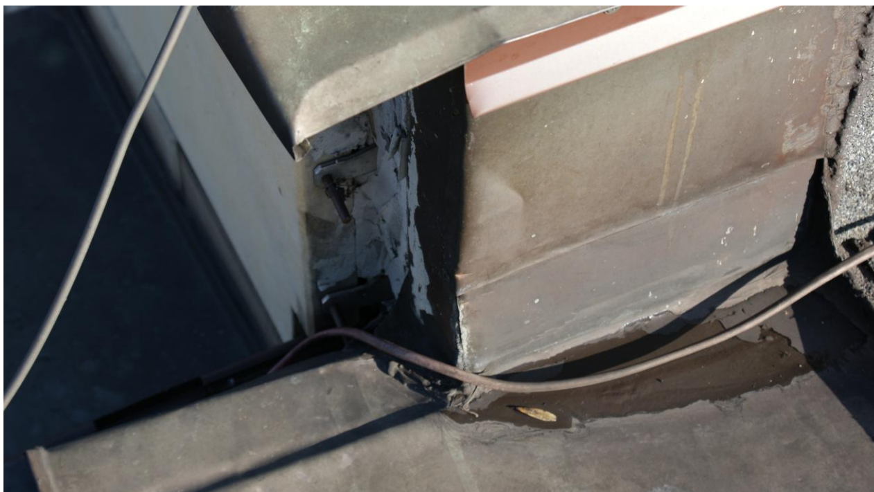
Zdjęcie nr 16- brak obróbki okładziny kamiennej elewacji powoduje ,że woda opadowa z dachu wlewa się pomiędzy ścianę i okładzinę kamienną , powodując zamakanie izolacji termicznej i ścian
