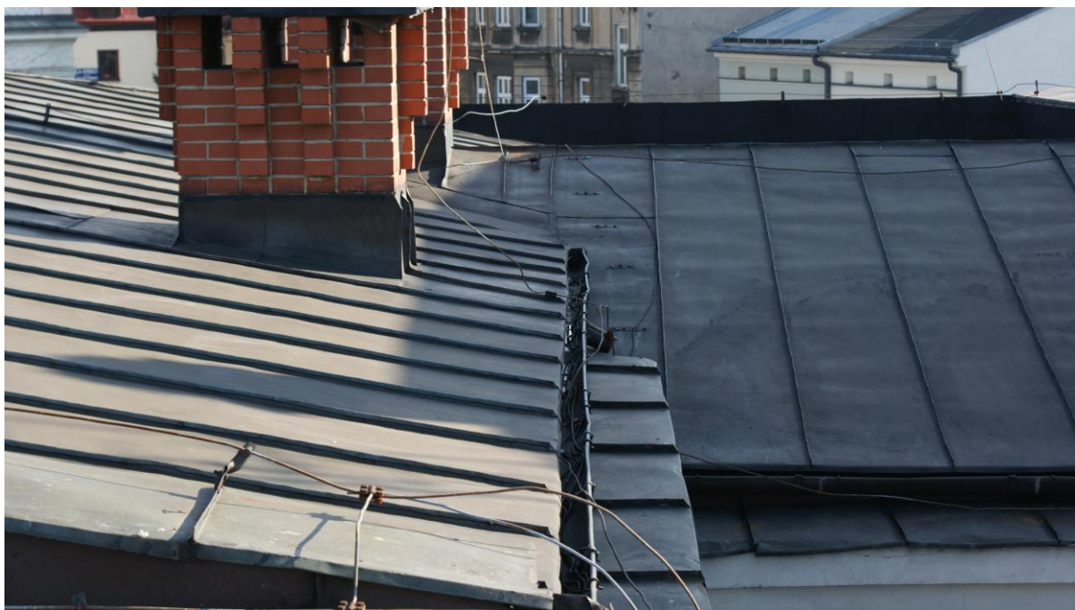
Zdjęcie nr 24- pocięta rynna dachowa i pas podtynkowy
