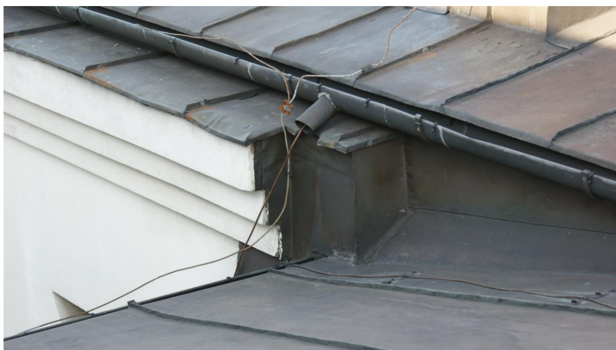
Zdjęcie nr 25 – przykład nieprawidłowego wykonania sztućca rynnowego i przenikania się attyk budynku
