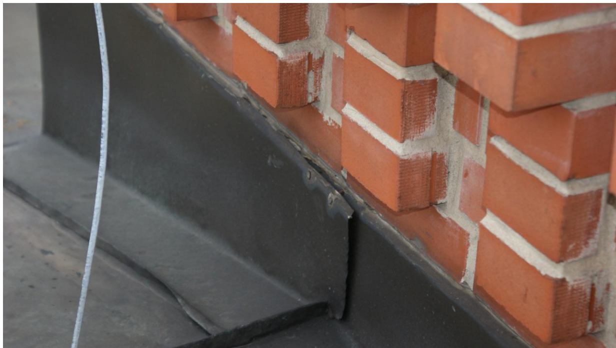
Zdjęcie nr 11 – przykład rozszczelnienie obróbki na wskutek ruchów termicznych
