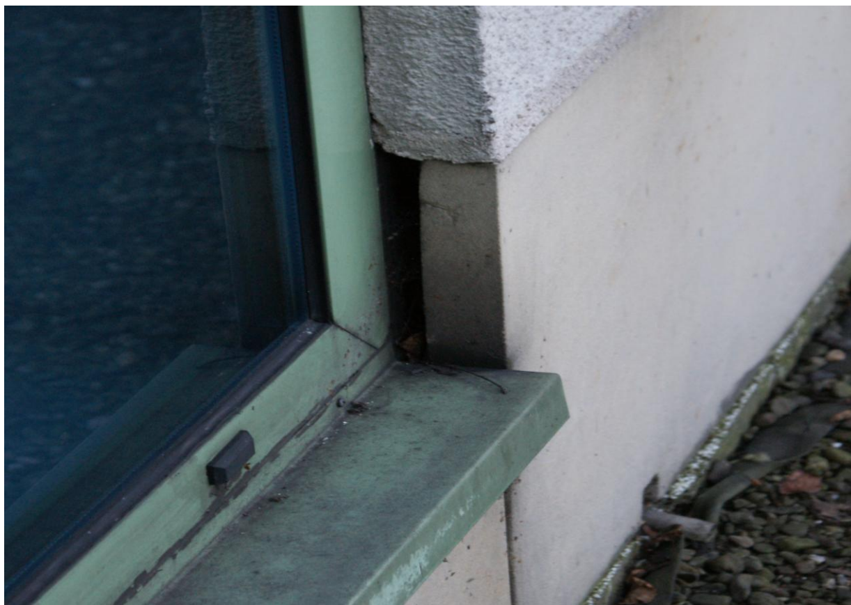
Zdjęcie nr 36- brak obróbki pomiędzy oknem a płytą kamienną
