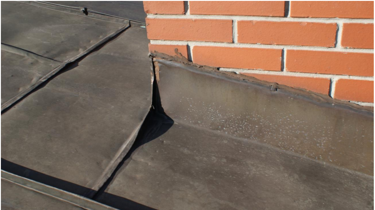
Zdjęcie nr 18 – widoczne odgięcia łączenia poziomego blach/ rąbek leżący /
