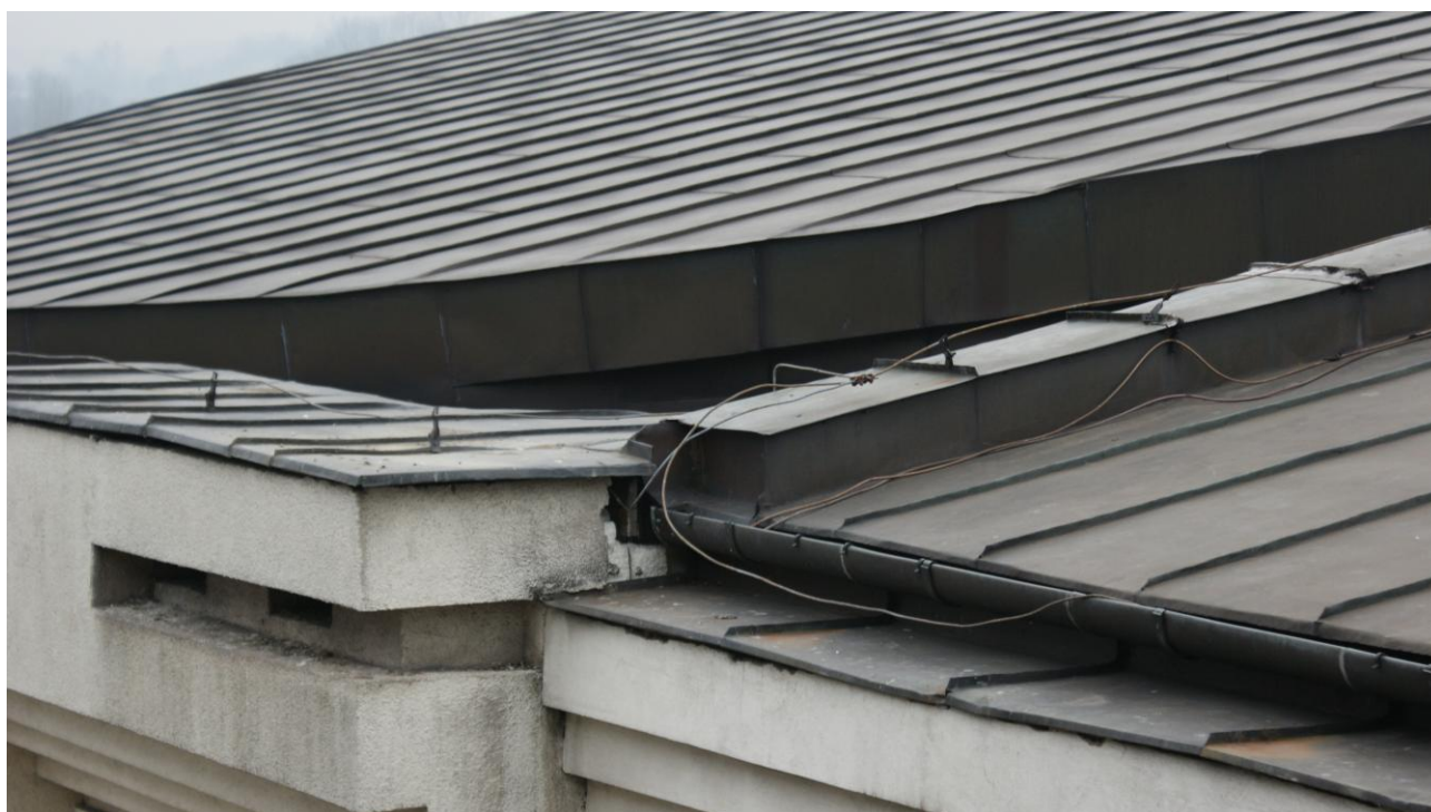
Zdjęcie nr 15- źle wykonane ścianki kolankowe na styku starego i nowego budynku. Rynna wchodząca w ściankę atykową z okapem uniemożliwiła poprawne zakończenie atyki nowo- dobudowywanej części.
