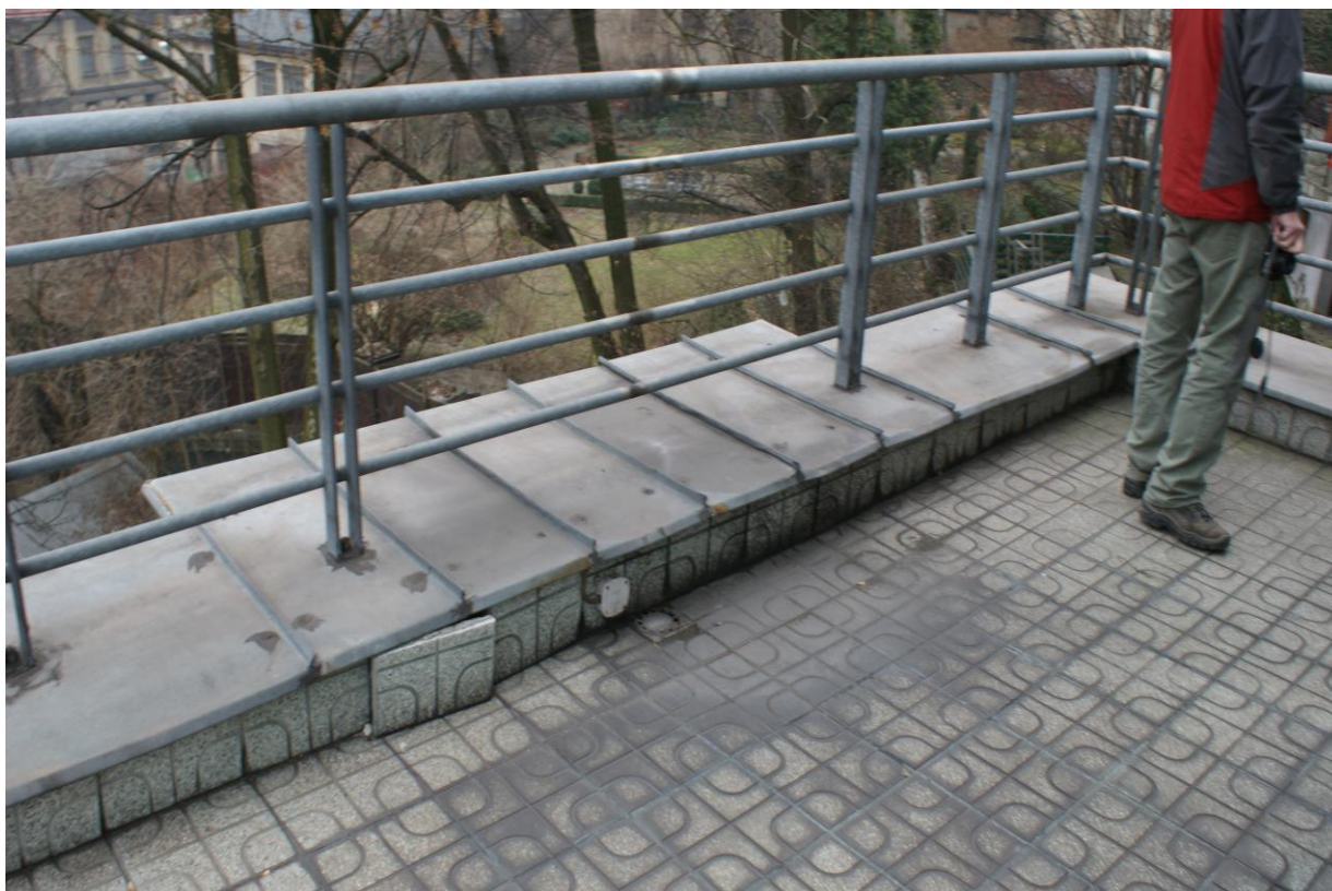
Zdjęcie nr 63- widok tarasu z odspojonymi płytkami
