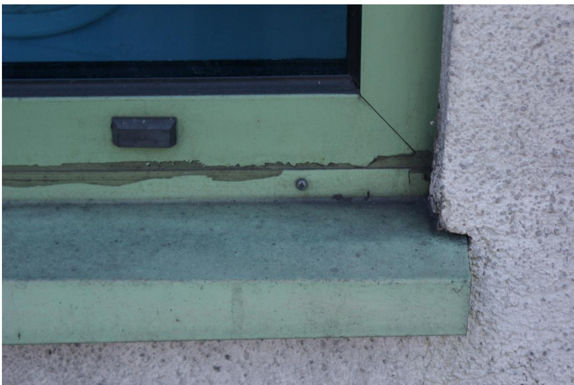
Zdjęcie nr 51 – przykład źle osadzonego parapetu
