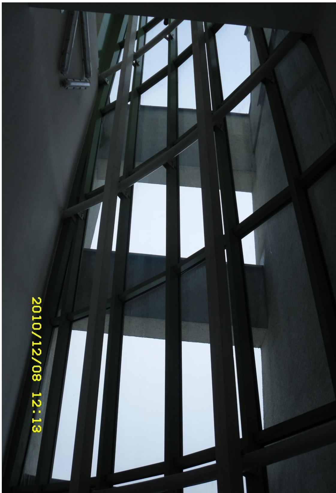
Zdjęcie nr 58 – ściana kurtynowa pochyla bez możliwości konserwacji bieżącej
