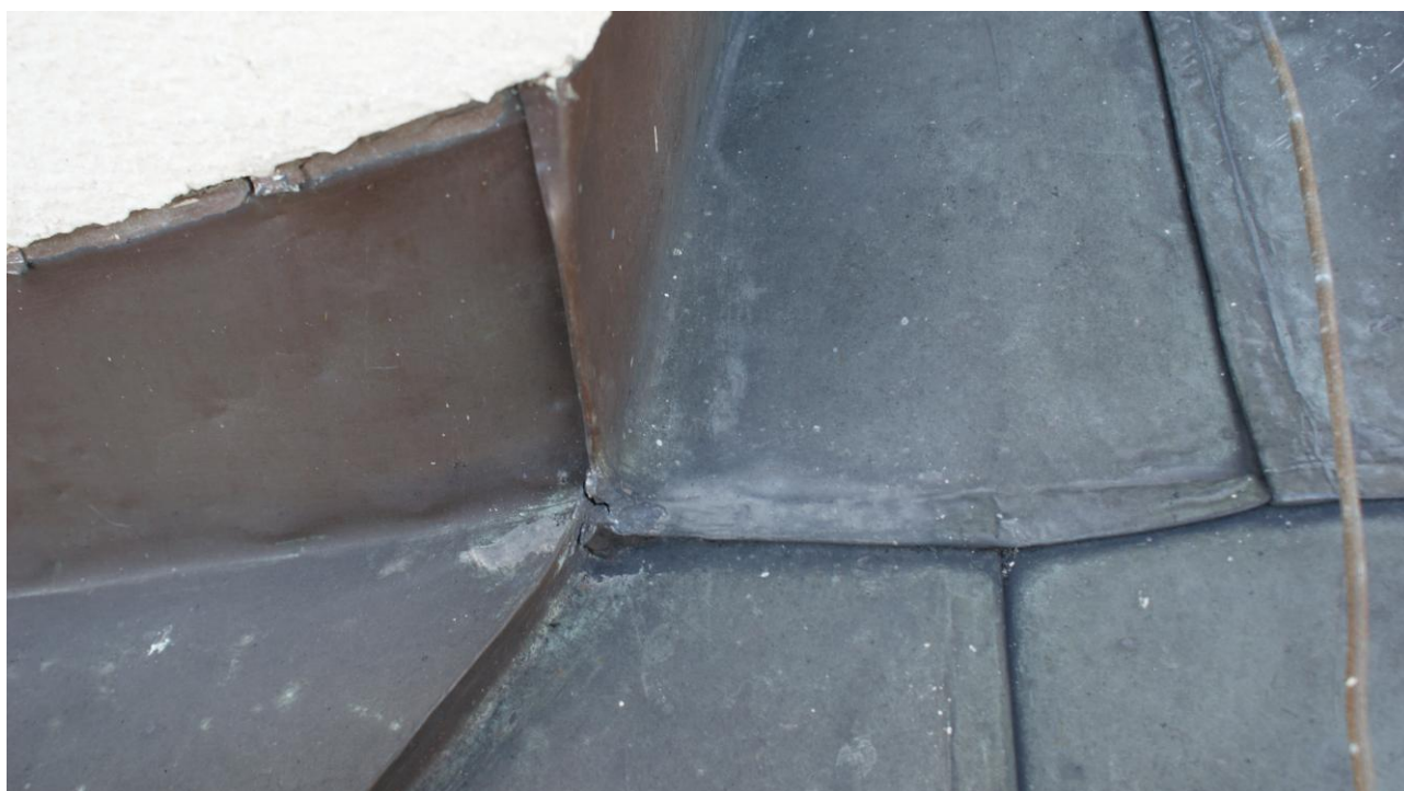
Zdjęcie nr 17 – uszkodzona blacha na łączeniu / rozerwana /
