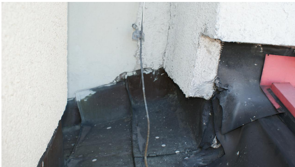
Zdjęcie nr 21- źle wykonana obróbka świetlika w połączeniu ze ścianą
