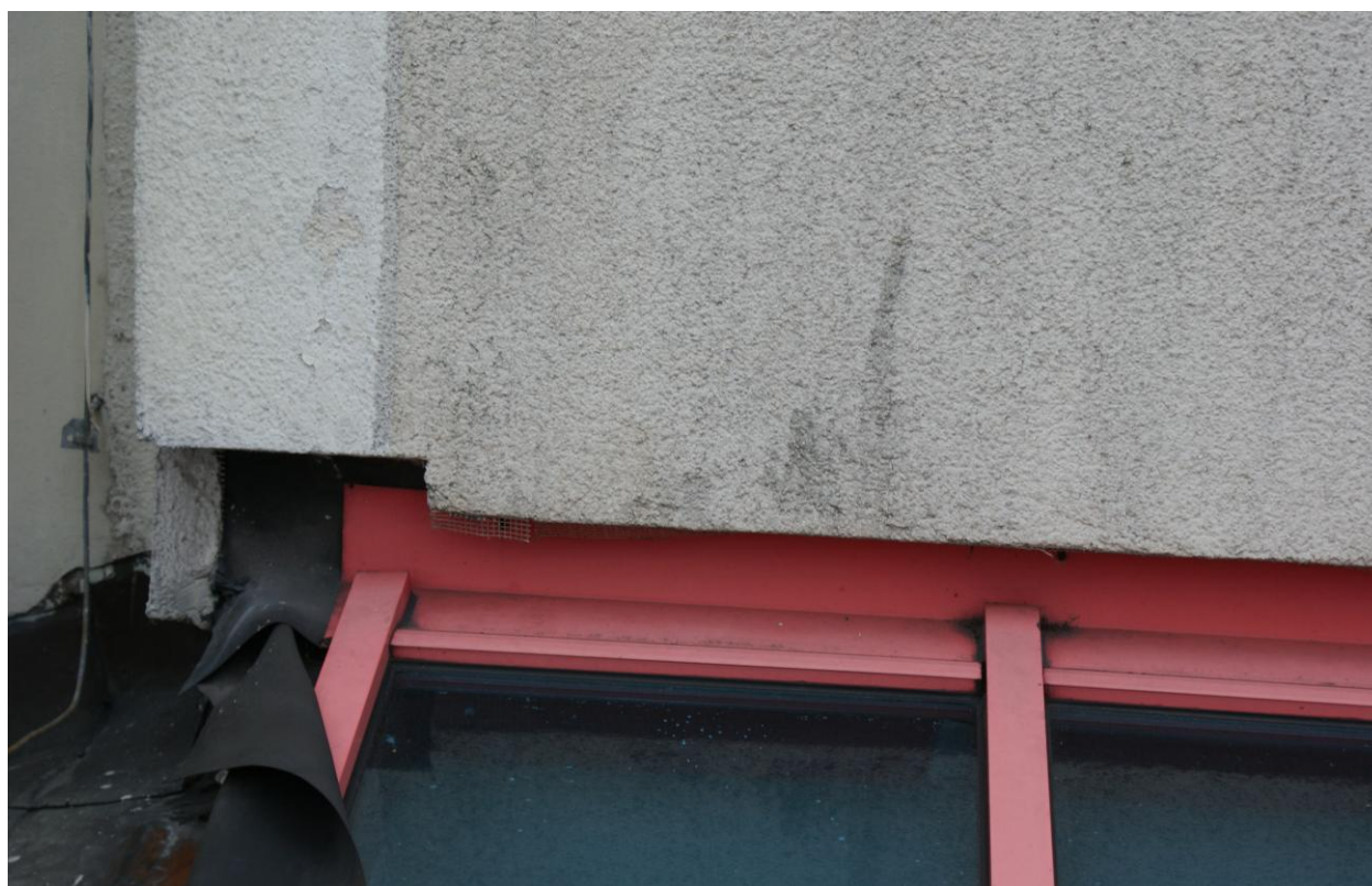
Zdjęcie nr 48 – przykład wady obróbki świetlika
