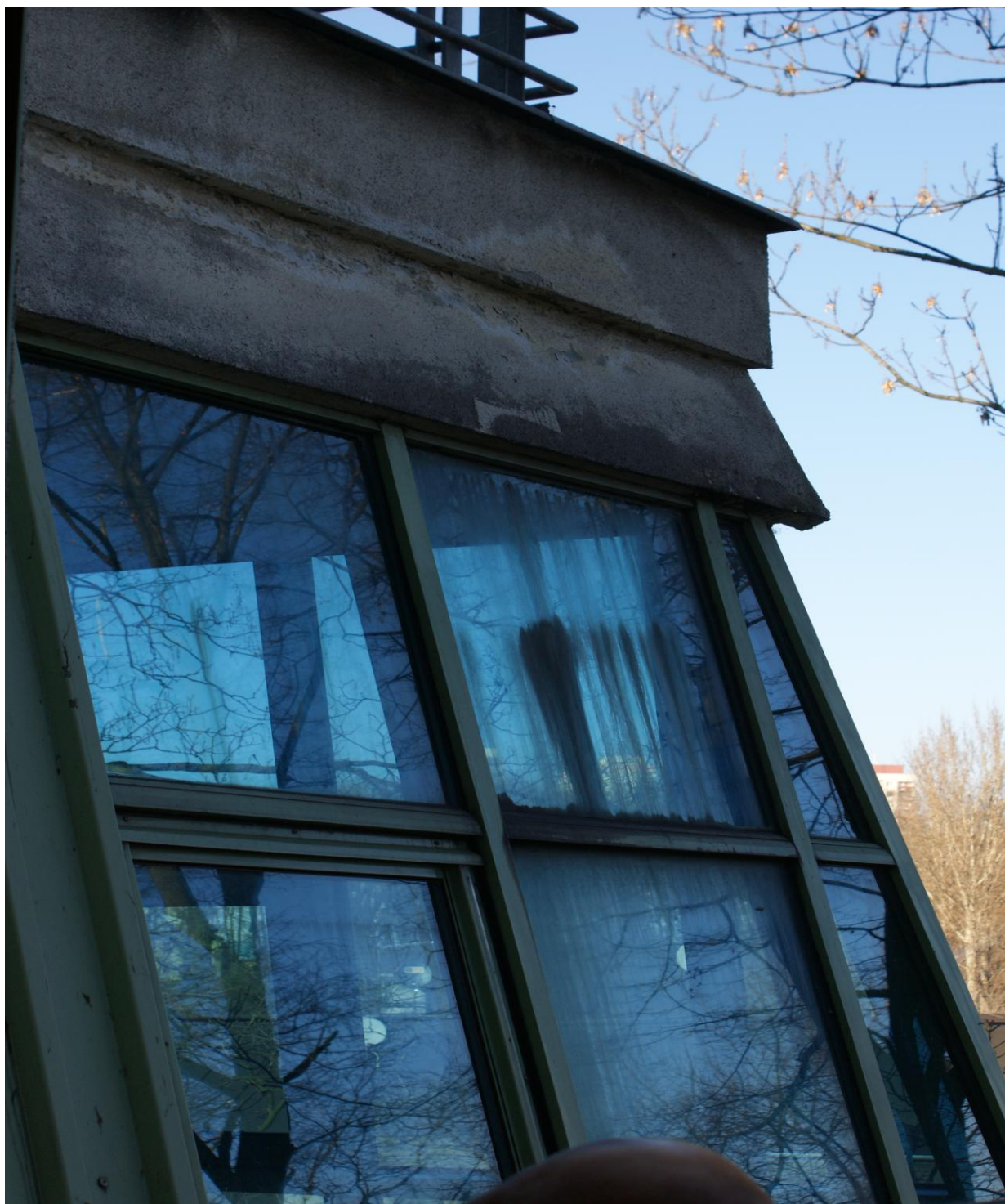
Zdjęcie nr 65 – wpływ przeciekającego tarasu na elewacje BSO / woda wycieka spod warstw ocieplających i płynie podszycach ścianki kurtynowej /
