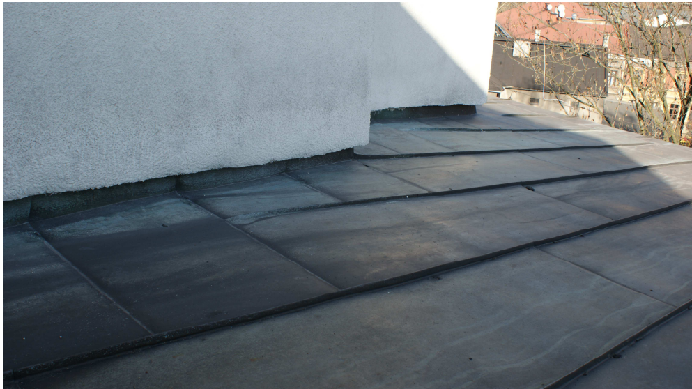
Zdjęcie nr 10 – za małe obróbki elementów pionowych , wykonane jako jednodzielne
