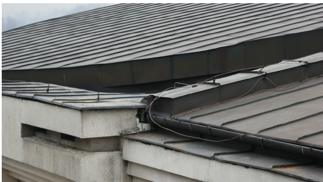
Zdjęcie nr 15- źle wykonane ścianki kolankowe na styku starego i nowego budynku. Rynna wchodząca w ściankę attykową z okapem uniemożliwiła poprawne zakończenie attyki nowo- dobudowywanej części.
