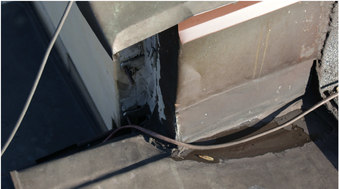
Zdjęcie nr 16- brak obróbki okładziny kamiennej elewacji powoduje ,że woda opadowa z dachu wlewa się pomiędzy ścianę i okładzinę kamienną , powodując zamakanie izolacji termicznej i ścian
