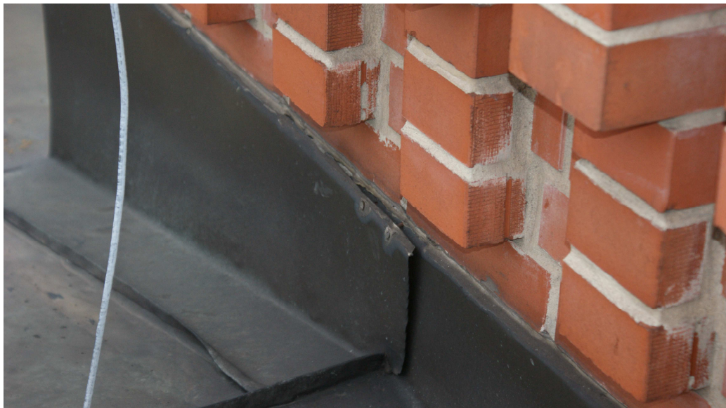
Zdjęcie nr 11 – przykład rozszczelnienie obróbki na wskutek ruchów termicznych
