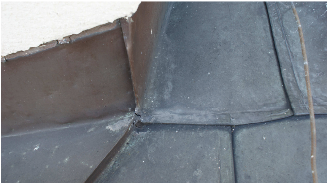
Zdjęcie nr 17 – uszkodzona blacha na łączeniu / rozerwana /
