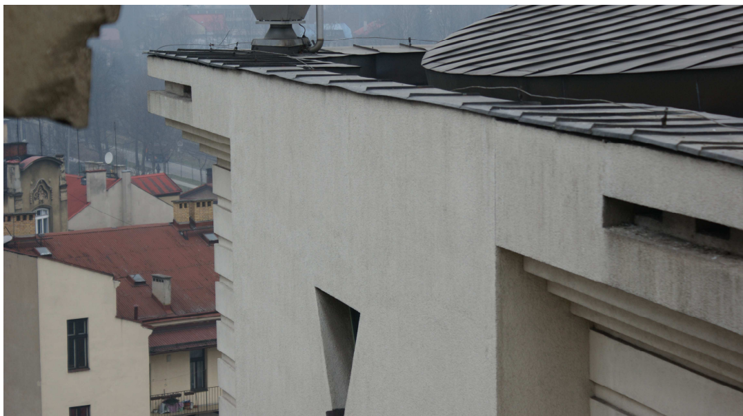
Zdjęcie nr 12- pocięte obróbki ścian attykowych , zły spadek obróbek
