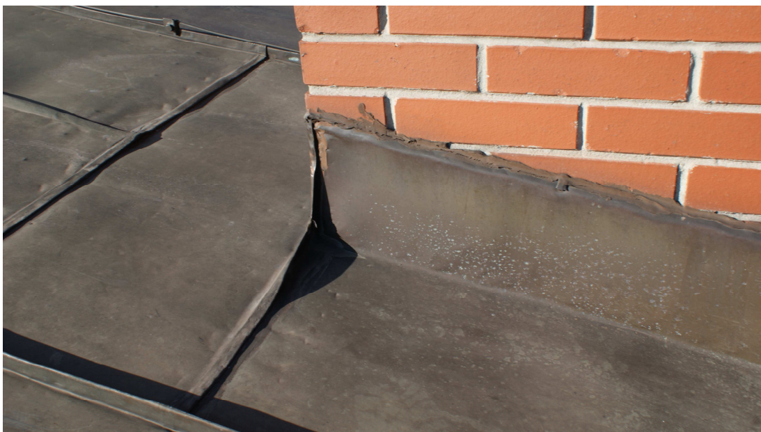
Zdjęcie nr 18 – widoczne odgięcia łączenia poziomego blach/ rąbek leżący /
