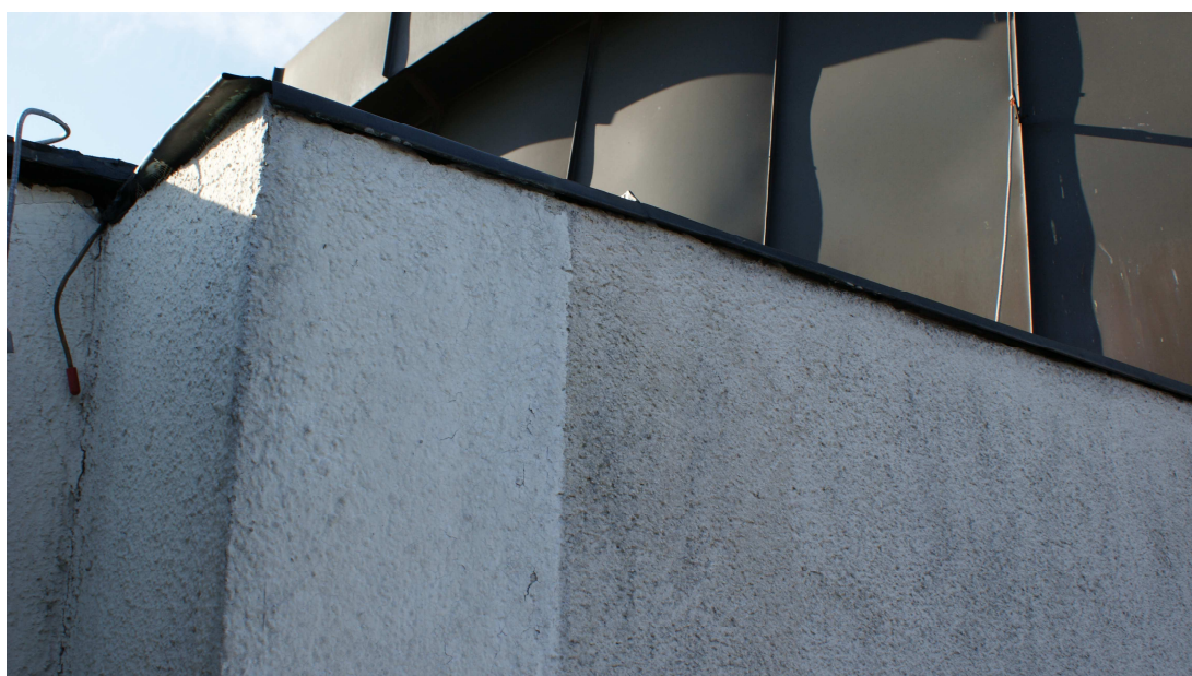
Zdjęcie nr 13 – za mało wypuszczona obróbka ścianki attykowej nie chroni ścianki
