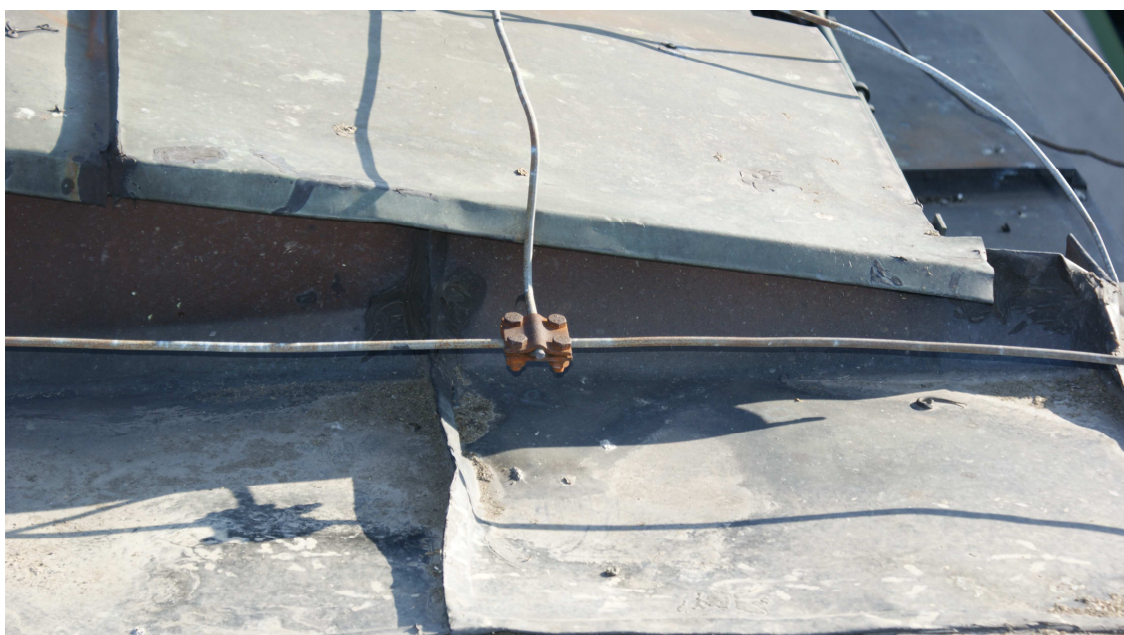
Zdjęcie nr 14 – przykład braku lutowani obróbki , miejsce newralgiczne zalane lepikiem
