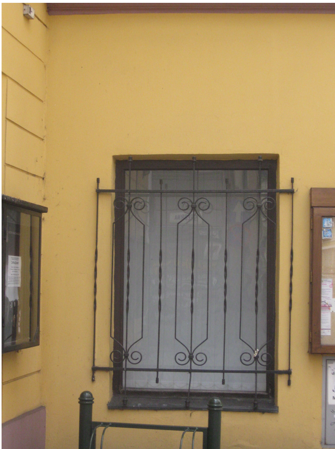
Fotografia nr 5. Istniejące okno w osi 11 budynku administracyjnego Rynek 1 w elewacji od strony ulicy Tadeusza Regera
