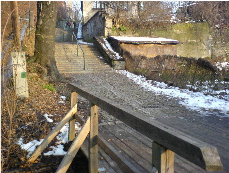
Widok ul. Schodowej, w rejonie mostu przez kanał Młynówki. Most wymagający przebudowy dla potrzeb dojazdu do projektowanego parkingu.
