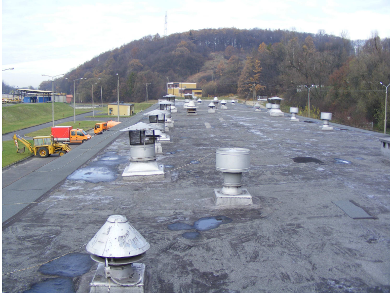
Demontaż wskazanych wywietrzaków dachowych z zaślepieniem otwory w dachu wg projektu Nowe pokrycie dachu z warstwą termomodernizacji wełny mineralnej i obróbkami przy kominkach
